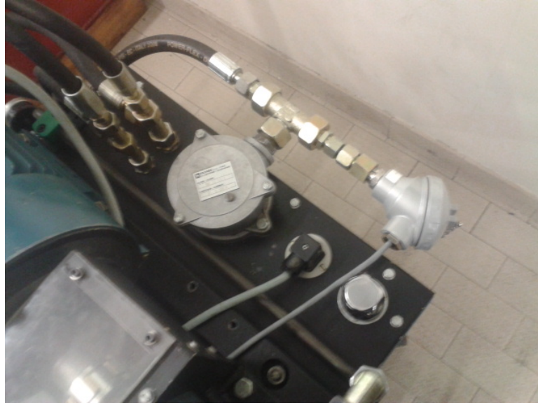
Fig 4.29 Posicionamento Pt100 na linha que se direcciona para o reservatório
