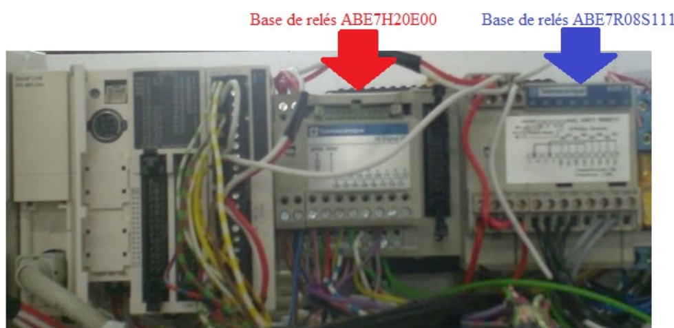
Fig. 4.5 Figura ilustrativa das ligações entre as duas bases de relés e o autómato
