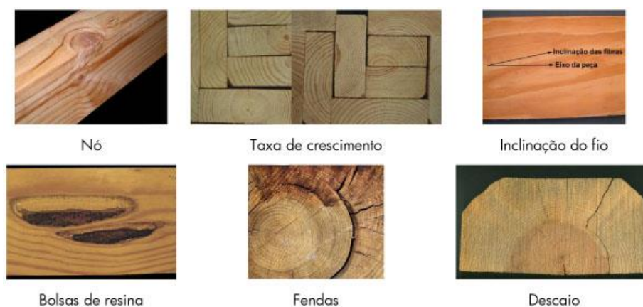
Figura 2.4 – Defeitos nas madeiras [4]
