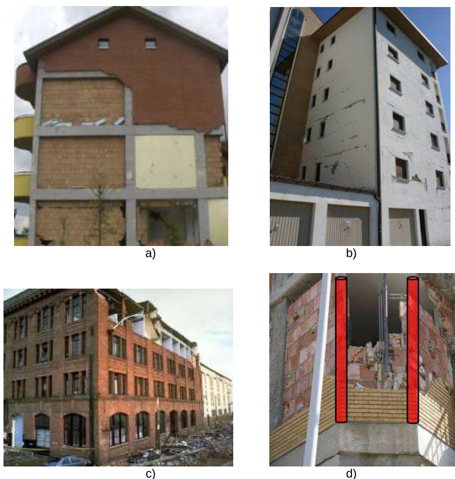
Figura 2.12 - Danos em painéis de alvenaria a) desligamento à estrutura [3]; b) Fissuração generalizada no edifício [3]; c) colapso para fora do plano [30]; d) Colapso devido à falta de cintagem [3].
