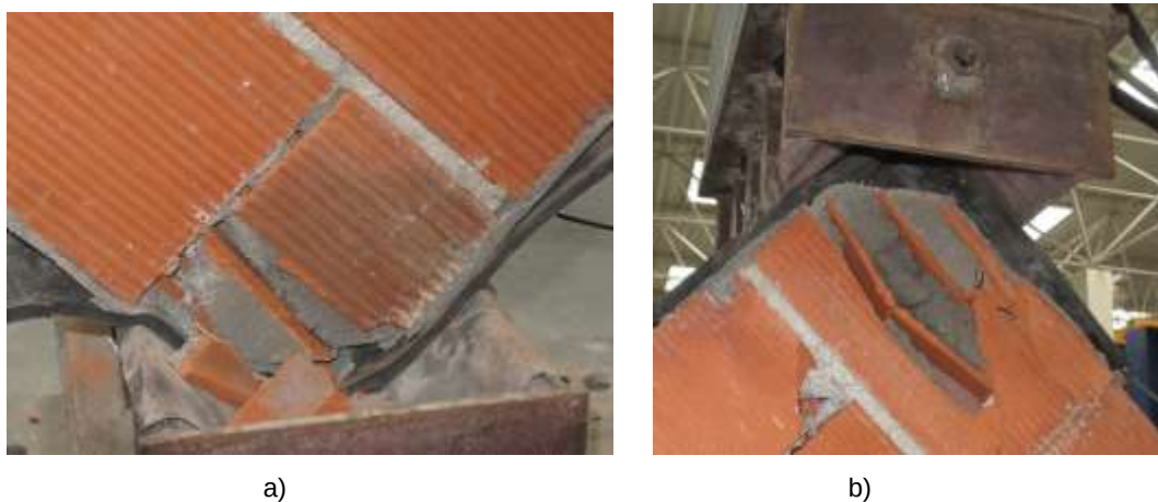
Figura 4.19 – Esmagamento do tijolo e argamassa das extremidades dos muretes; a) Provete B(1); b) Provete B(2).
