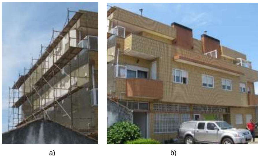
Figura 5.14 – Fotografia da parede ensaiada (a) e da fachada frontal do edifício (b).
