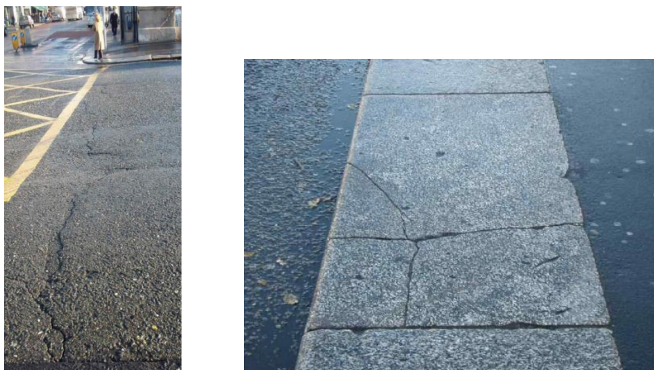
Fig. 111 – Fissuras nos encontros do tabuleiro e no passeio [40]
