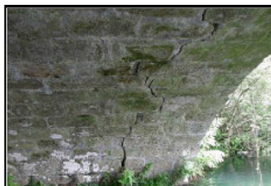
Fig. 71 – Fissura longitudinal no arco [16]
