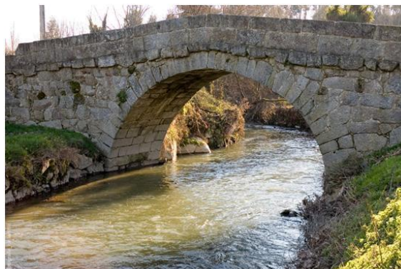
Fig. 64 – Abertura de juntas, Ponte de Espindo [34]
