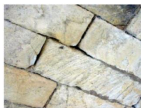
Fig. 69 – Perda de argamassa [4]
