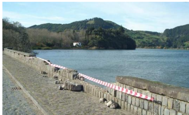
Fig. 73 – Destacamento dos guarda-corpos [35]
