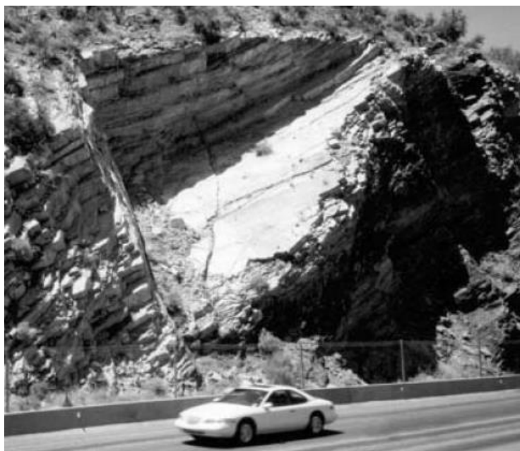
Fig 3.1 – Rotura em cunha formada pela intersecção de dois planos (Wyllie e Mah, 2004)
