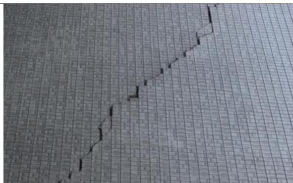
Figura 4.41 – Fissuração severa (Edifício 19)
