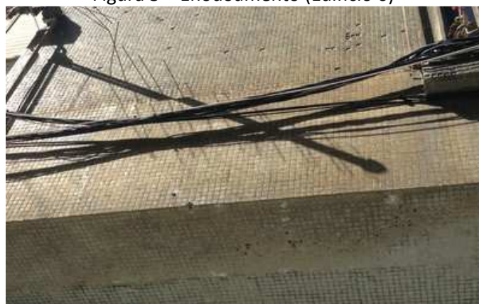
Figura 5 – Alteração de cor e brilho (Edifício 12)
