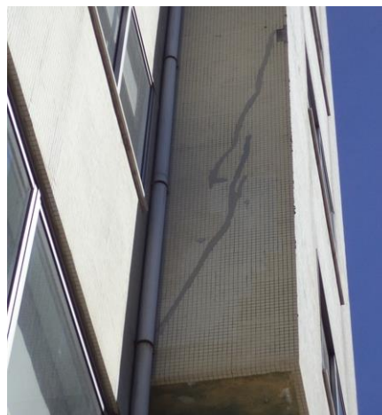
Figura 5.11 – Fissuração da consola (Edifício 17)
