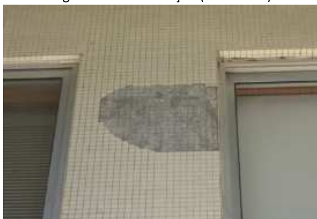
Figura 14 – Descolamento localizado (Edifício 17)
