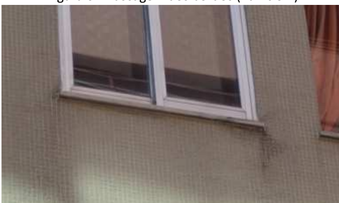
Figura 8 – Sujidade superficial (Edifício 9)
