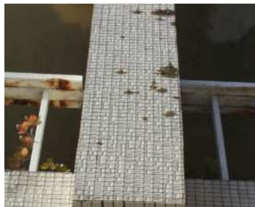
Figura 10 – Crescimento biológico (Edifício 21)
