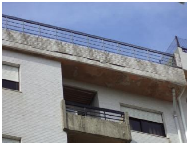
Figura 5.10 – Fissuração da platibanda (Edifício 4)
