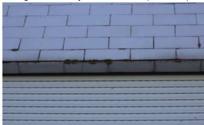
Figura 7 – Crescimento biológico (Edifício 6)
