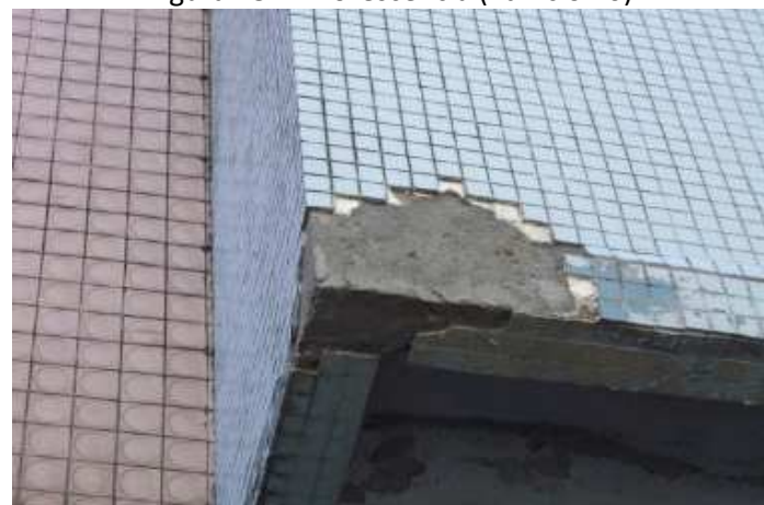
Figura 15 – Descolamento localizado (Edifício 10)
