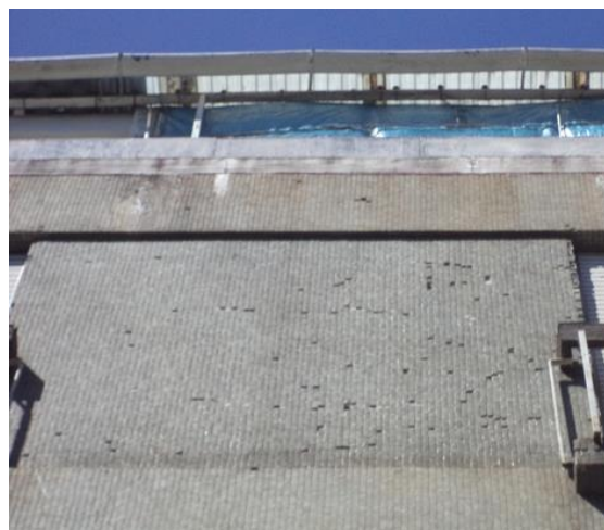
Figura 5.13 – Descolamento generalizado (Edifício 12)
