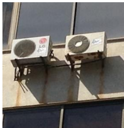
Figura 5.4 – Enodoamento, Escorrências de elementos metálicos (Edifício 24)
