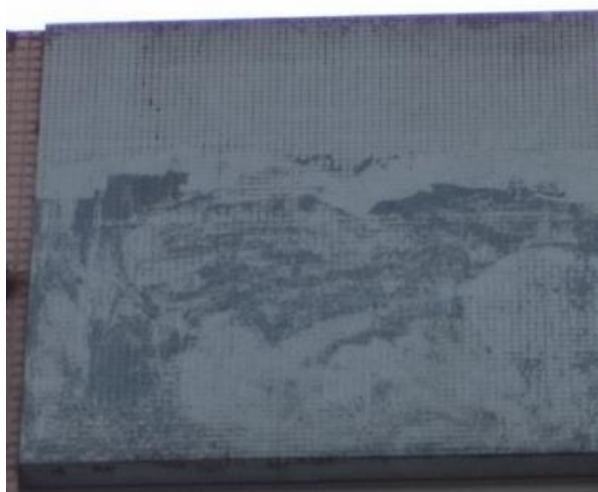
Figura 5.3 – Alteração da cor e brilho (Edifício 10)
