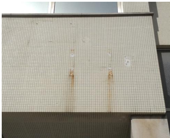
Figura 3.7 – Escorrências de elementos metálicos
