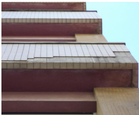
Figura 5.12 – Descolamento localizado (Edifício 11)
