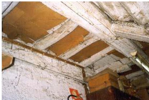
Figura 4.12 – Vista de patamar das escadas onde se observa a cadeia a servir de apoio a uma das pernas da escada [40]
