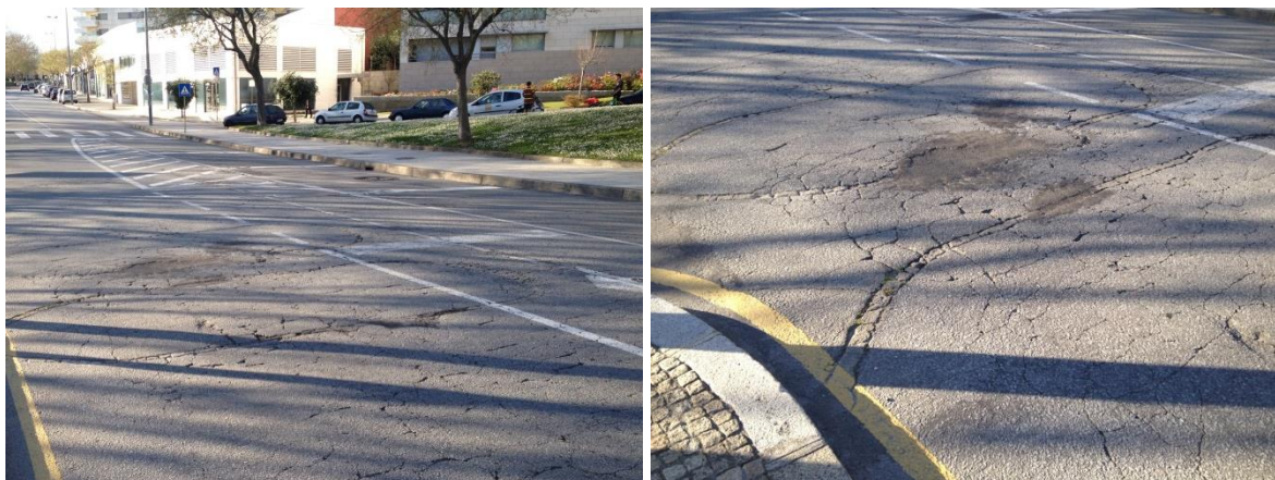
Figura 61 - Estado do pavimento em algumas zonas
