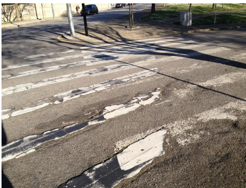
Figura 62 - Pormenor de uma passadeira que está em mau estado e com as marcas sobrepostas
