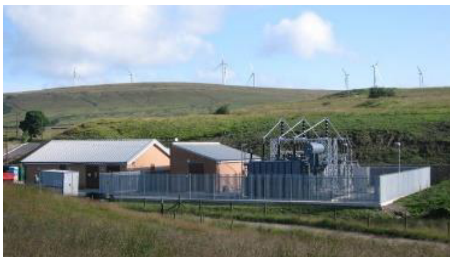
Fig. 30 - Subestação Elétrica (Anderson 2012)
