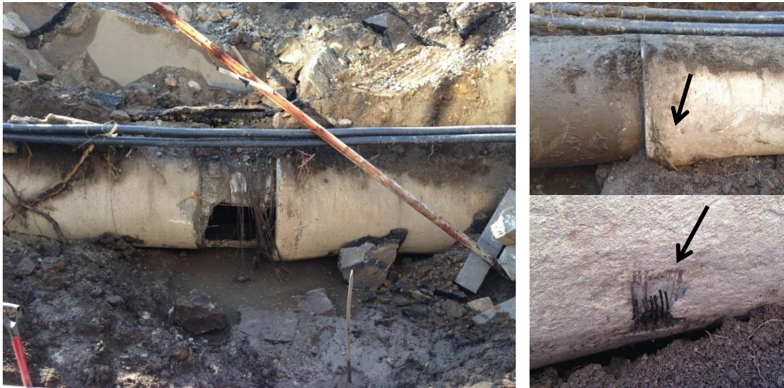
Figura 10 - Local da rutura e estado de conservação da conduta
