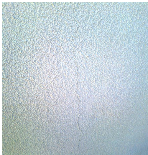
Fig.5.110 - Fissura na fachada O.
