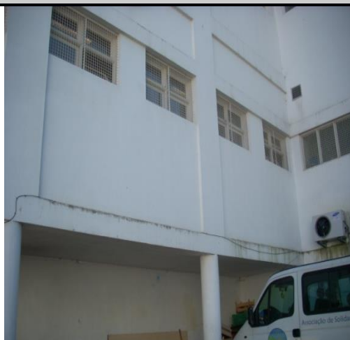
Fig.5.84 - Sujidade e manchas na fachada N.
