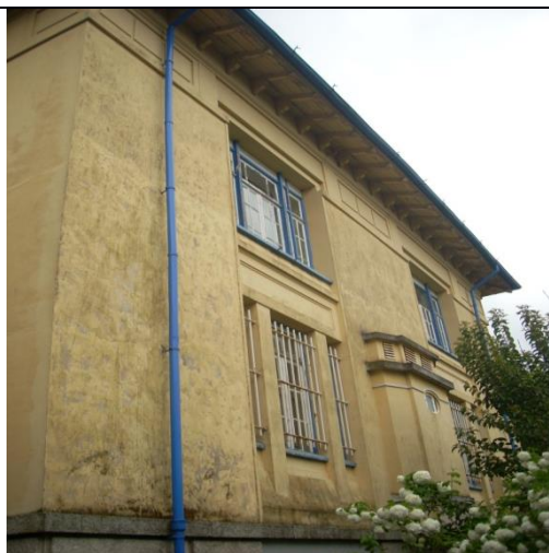
Fig.5.19 - Perda do poder de cobertura, descasque, colonização biológica e manchas na fachada O1.
