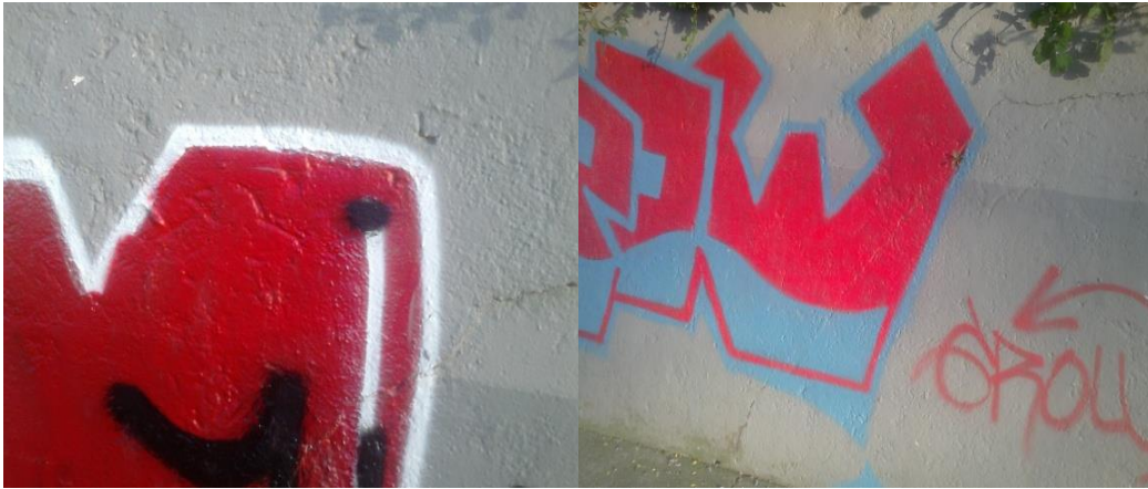
Fig.3.48 - Muros com revestimento de tinta pintados com grafite.
