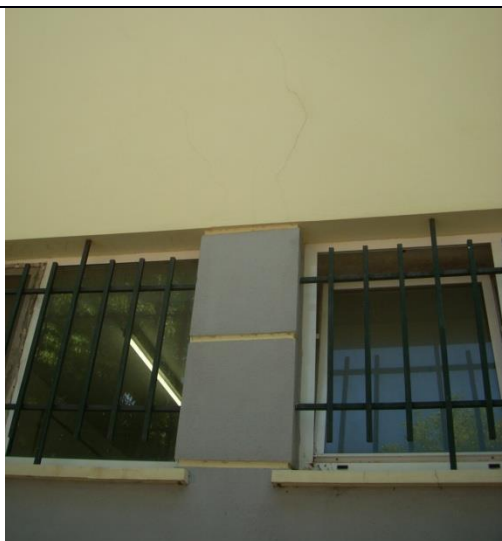
Fig.5.26 - Fissura na fachada N2.
