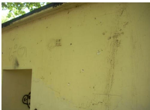
Fig.5.31 - Grafites, bicos de alfinete e sujidade na fachada E1.
