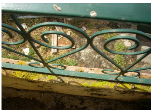
Fig.5.130 - Colonização biológica na fachada N2.
