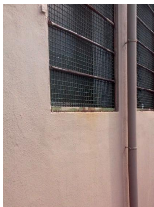
Fig.3.55 - Acabamento de sistema ETICS manchado com ferrugem proveniente do gradeamento da janela.
