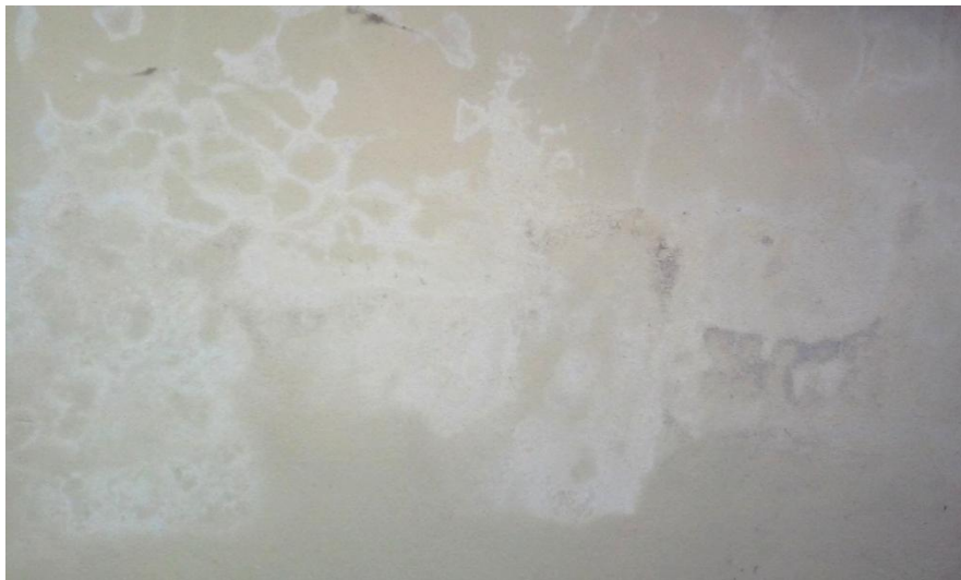
Fig.3.25 - Degradação da película de tinta por humidade.
