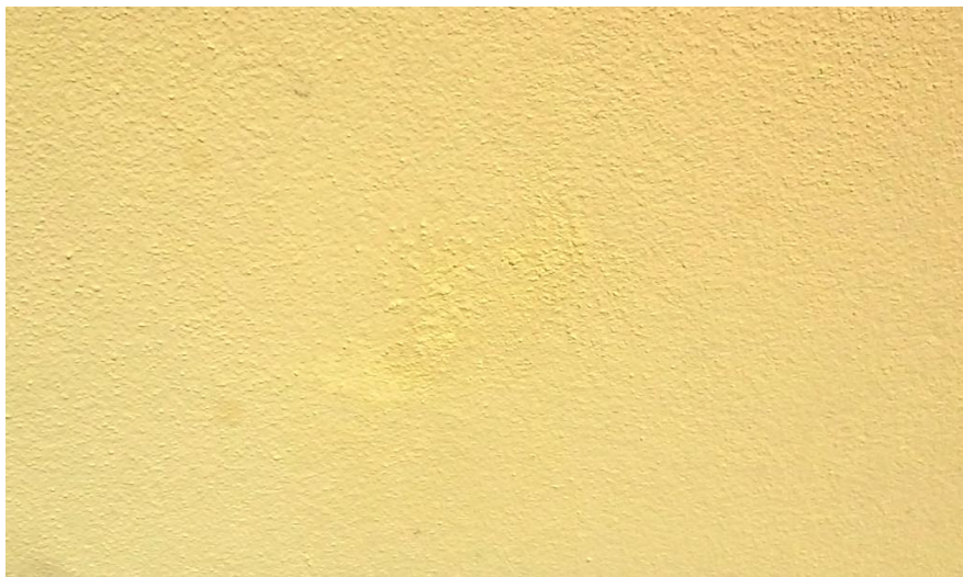
Fig.3.11 - Alteração da cor da fachada.
