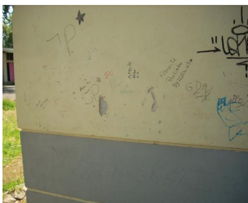
Fig.5.38 - Descasque e grafites na fachada E2.
