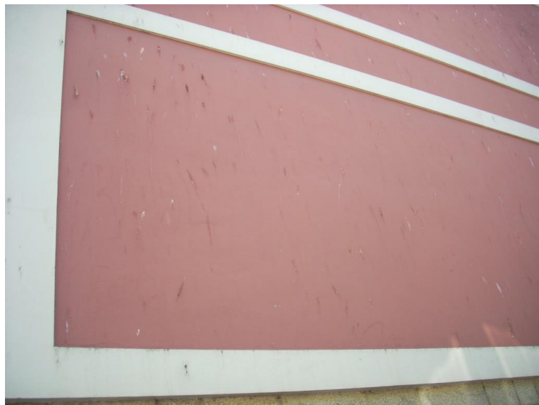
Fig.4.10 - Deterioração da película de tinta por fezes de pombos.
