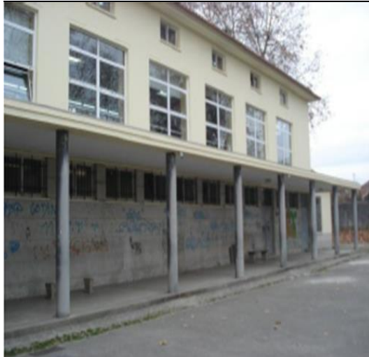
Fig.5.46 - Fachada Sul com grafites e sujeidade.
