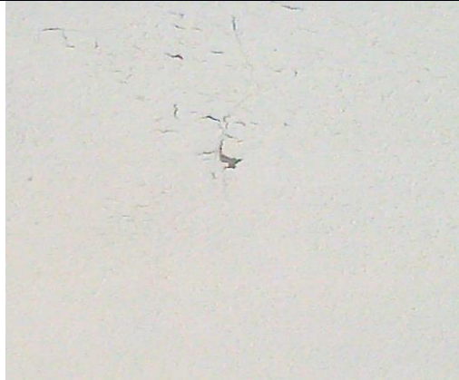
Fig.5.105 - Descasque na fachada N.
