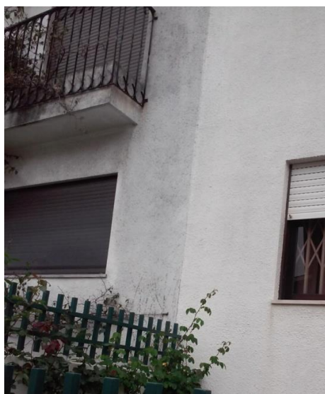
Fig.3.47 - Perda do poder de cobertura da tinta de fachada.
