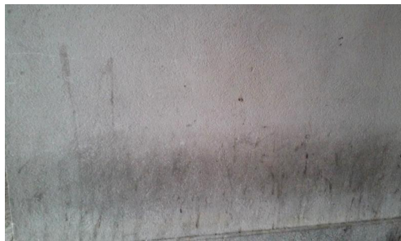
Fig.3.54 - ETICS degradado pela sujidade.
