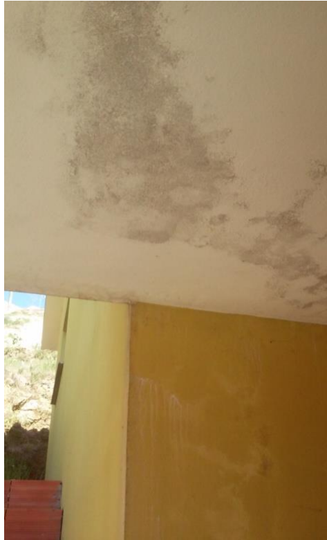
Fig.3.24 - Efeitos na tinta exterior devido à percolação da água no interior das paredes.
