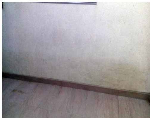
Fig.5.121 - Sujidade na fachada O.
