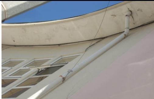
Fig.5.61 - Sujidade, fissuração e descasque na fachada S.
