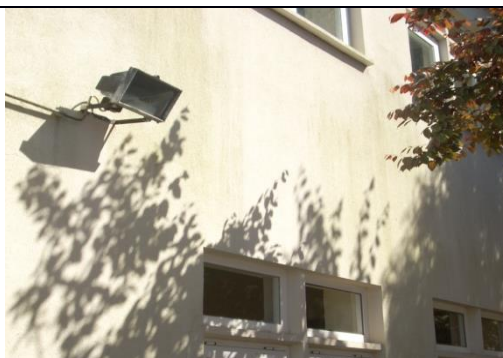
Fig.5.64 - Manchas e colonização biológica na fachada E.
