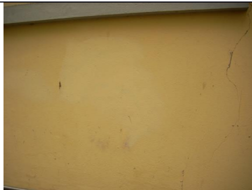
Fig.5.7 - Descoloração e fissuras na fachada N4.
