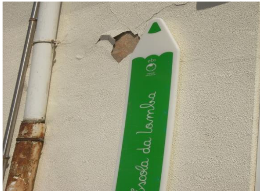
Fig.5.62 - Fissuração, descasque da película de tinta e reboco na fachada S.
