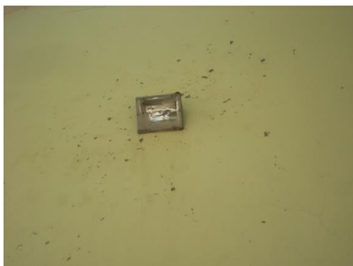
Fig.5.34 - Destacamento e sujidade na fachada E1.
