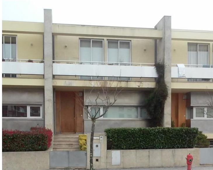
Fig.3.36 - Sujidade acumulada devido a escorrências.
