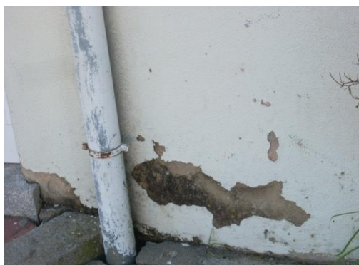
Fig.5.67 - Destacamento na fachada O.
