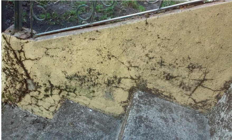
Fig.3.17 - Tinta fissurada com musgo.
