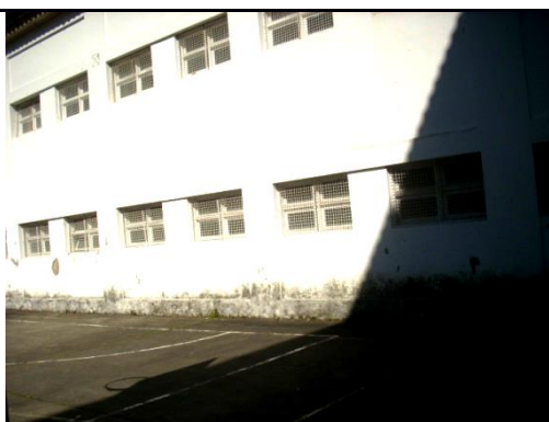
Fig.5.89 - Destacamento e colonização biológica na fachada O2.
