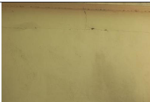
Fig.5.33 - Sujidade e fissuração na fachada E1.
