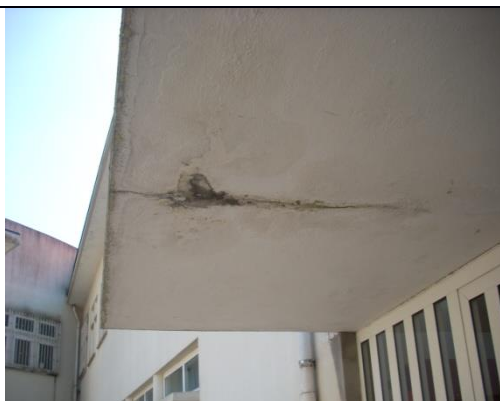
Fig.5.68 - Saponificação na fachada O.
