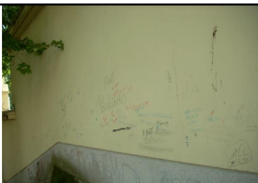
Fig.5.30 - Grafites e fissuração na fachada E1.
