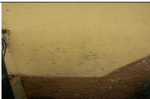
Fig.5.129 - Destacamento do revestimento e colonização biológica na fachada N2.
