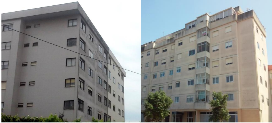
Fig.3.51 - Fachadas com alteração de cor nas zonas de vigas e pilares.
