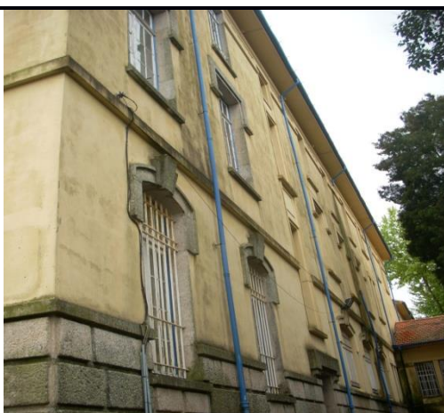
Fig.5.17 - Fissuração e descoloração na fachada O2.
