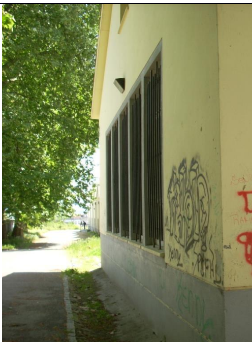
Fig.5.37 - Grafites e sujidade na fachada E2.
