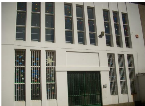
Fig.5.87 - Manchas e sujidade na fachada O1.
