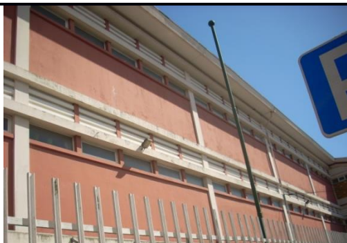
Fig.5.79 - Manchas, fissuras e sujidade na fachada O.
