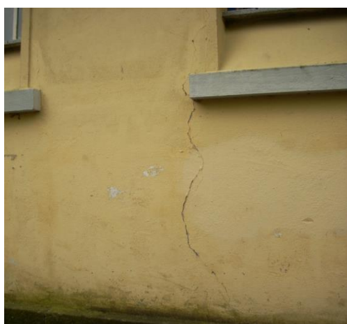
Fig.5.8 - Fissuras, colonização biológica, descoloração e descasque na fachada N4.
