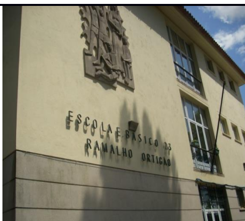
Fig.5.39 - Descoloração na fachada O1.
