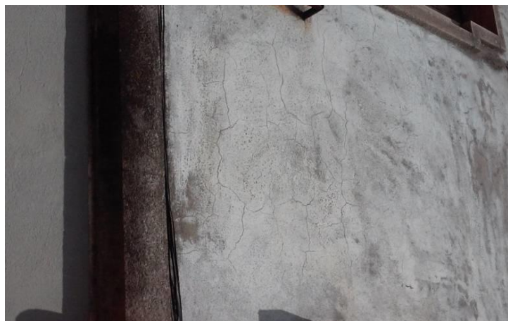
Fig.3.40 - Parede exterior fissurada em toda a sua altura.
