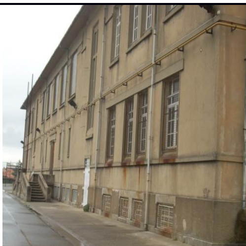
Fig.5.12 - Perda de poder de cobertura, manchas, descasque e fissuração na fachada S2.
