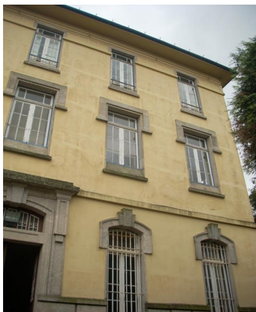
Fig.5.6 - Manchas e sujidade na fachada N3.
