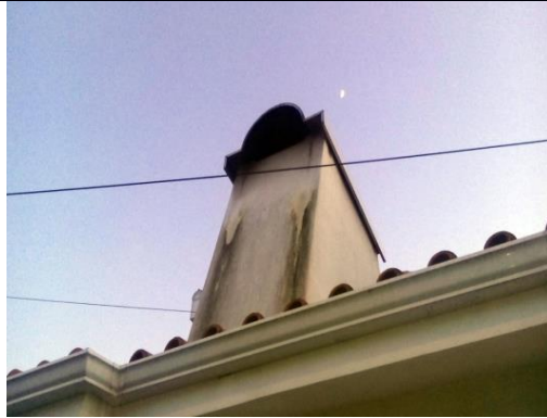
Fig.5.118 - Sujidade na fachada E.
