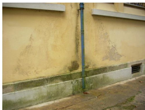
Fig.5.3 - Colonização biológica, descasque e manchas na fachada N2.
