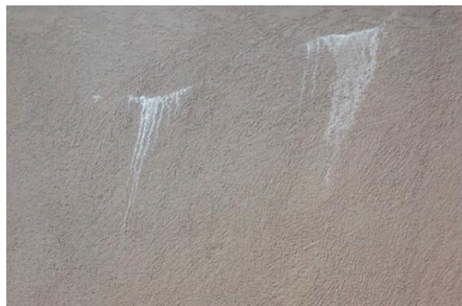
Fig.3.21 - Fissuração com cristalização de sais (Eflorescências).
