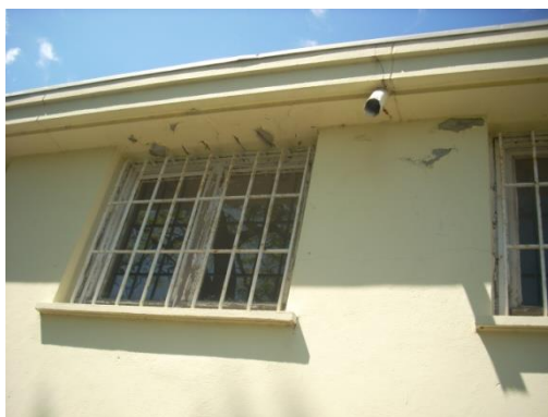
Fig.5.36 - Descasque e sujidade na fachada E1.
