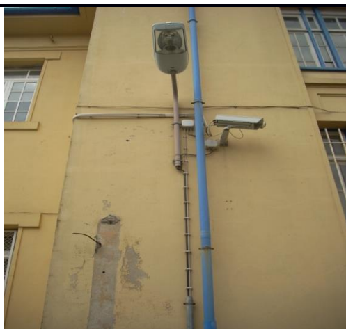
Fig.5.15 - Descasque, fissuração e sujidade na fachada E2.
