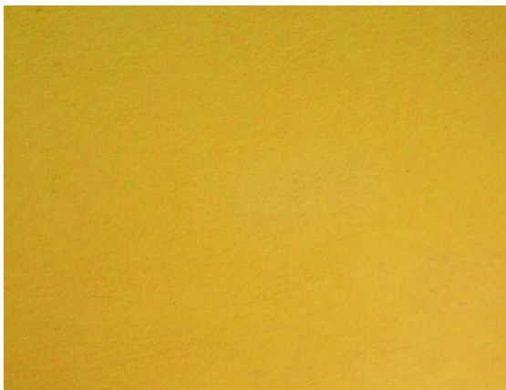
Fig.3.9 - Alteração de cor na fachada.
