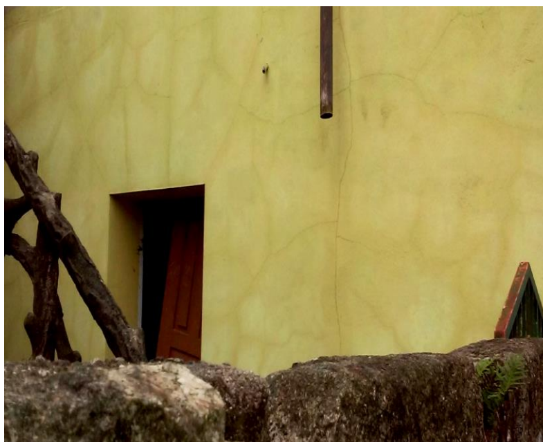
Fig.3.22 - Fachada com revestimento de tinta e reboco fissurado.
