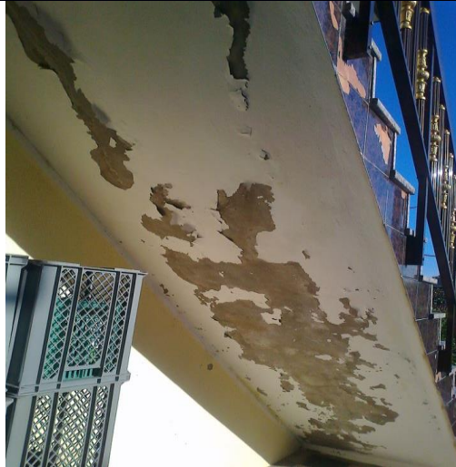
Fig.5.108 - Descasque na fachada E.
