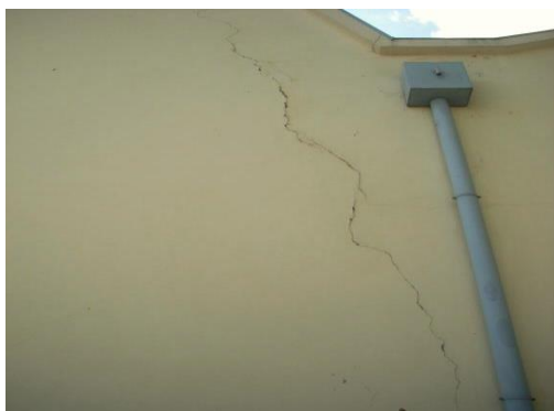
Fig.5.35 - Fissuração e sujidade na fachada E1.
