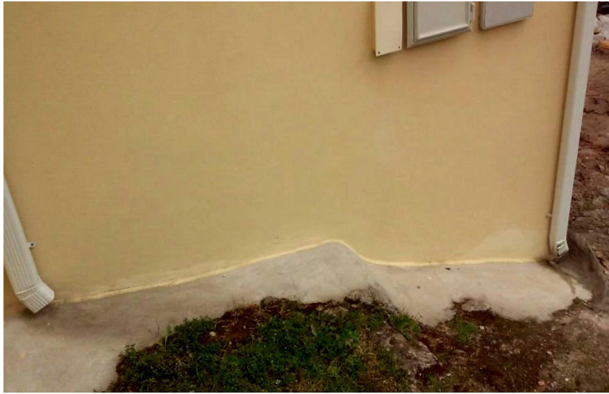
Fig.3.10 - Alteração de cor no fundo da parede.
