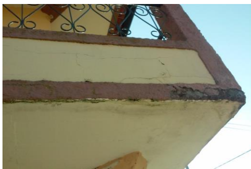
Fig.5.134 - Fissuração na fachada E1.
