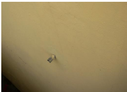
Fig.5.132 - Descoloração na fachada S.
