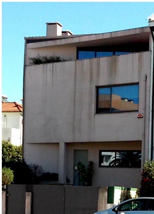
Fig.3.35 - Sujidade acumulada devido ao deficiente escoamento das águas pelos peitoris.
