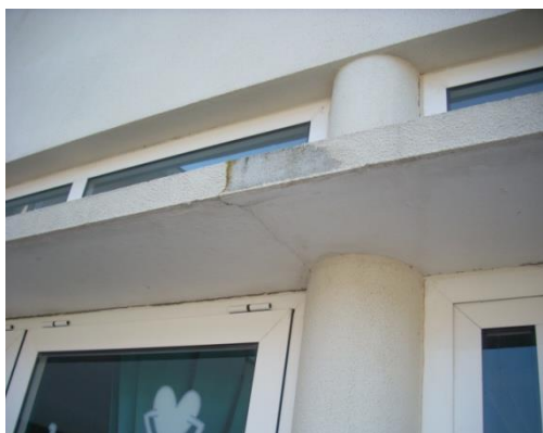
Fig.5.69 - Destacamento e fissuração na fachada O.
