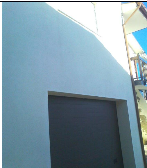
Fig.5.107 - Marcas de escorrência de água na fachada E.
