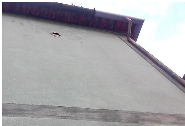
Fig.3.28 - Destacamento na película de tinta de fachada.
