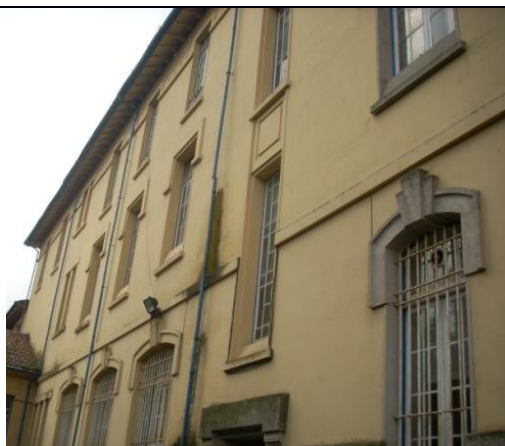
Fig.5.13 - Manchas, descoloração e fissuras na fachada E1.
