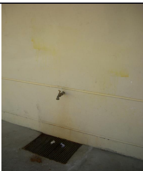
Fig.5.28 - Marcas de salpicos de água e sujeira na fachada S.
