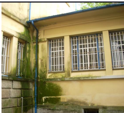
Fig.5.2 - Colonização biológica na interseção da fachada N2 e E.
