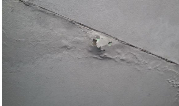
Fig.3.53 - Empolamento e destacamento do acabamento.
