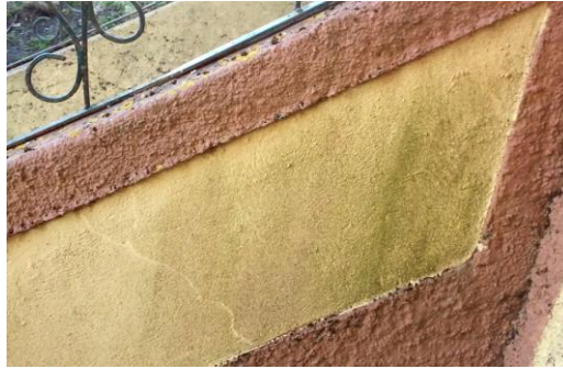
Fig.3.19 - Fungos em parede exterior.
