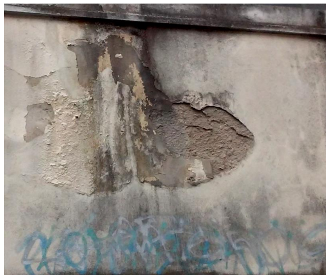
Fig.3.14 - Saponificação da tinta do muro exterior.
