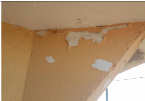
Fig.5.133 - Destacamento do revestimento na fachada E1.
