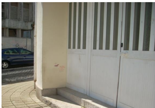
Fig.5.63 - Grafite e sujidade na fachada S.
