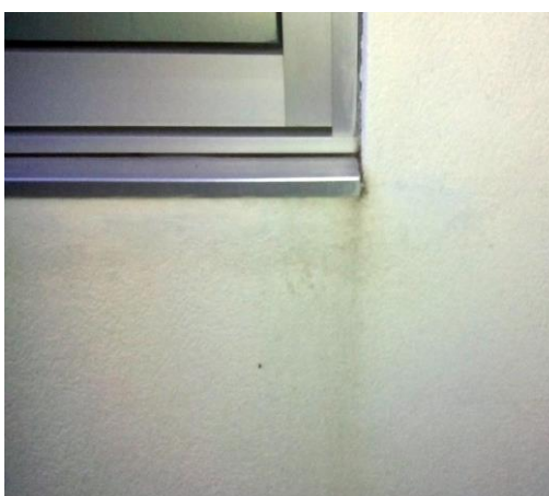
Fig.5.117 - Marcas de escorrência de água.
