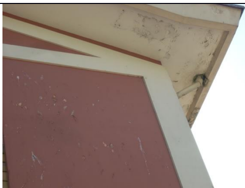
Fig.5.76 - Sujidade e saponificação na fachada N.
