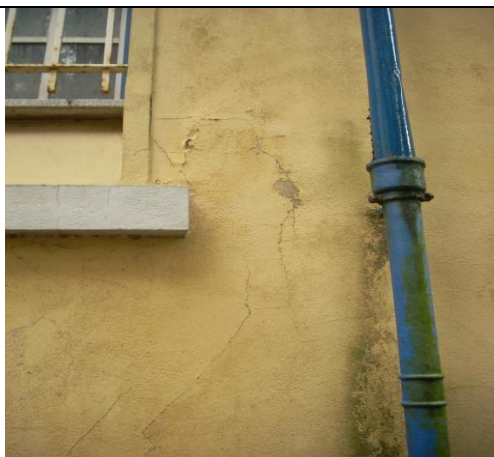
Fig.5.4 - Fissuração, descasque, manchas e colonização biológica na fachada N2.
