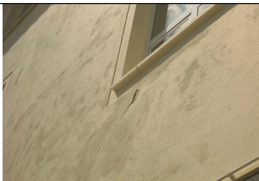
Fig.5.29 - Descasque na fachada S.
