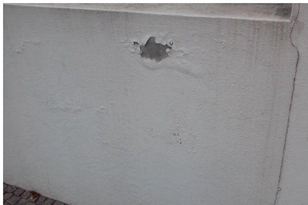
Fig.3.27 - Destacamento de tinta em muro exterior.
