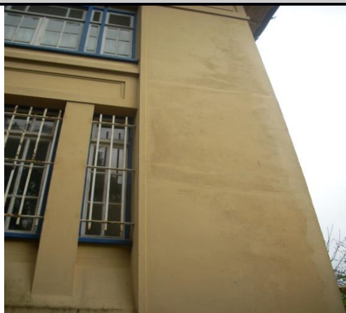
Fig.5.1 - Manchas e colonização biológica na fachada N1.
