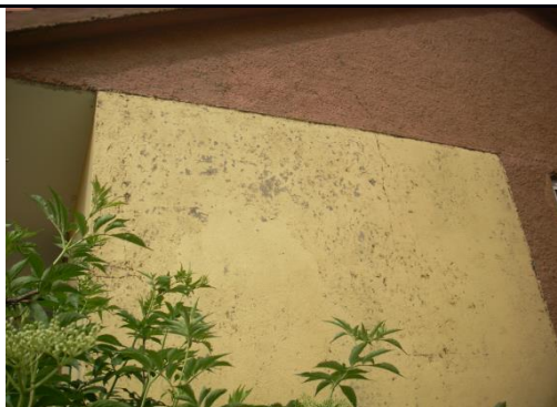
Fig.5.136 - Destacamento do revestimento na fachada O.
