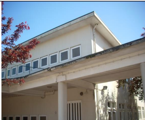
Fig.5.57 - Colonização biológica na fachada N1.
