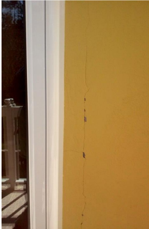
Fig.3.41 - Fissuração localizada com destacamento do acabamento no bordo de uma porta para exterior.
