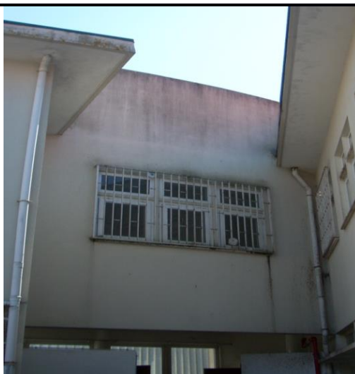
Fig.5.58 - Sujidade e marcas de escorrência de água na fachada N2.
