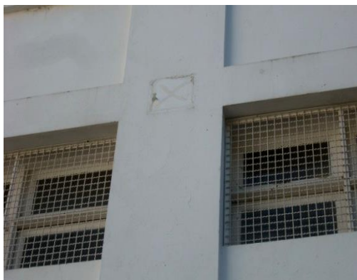
Fig.5.90 - Sujidade na fachada O2.
