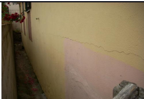
Fig.5.131 - Fissuras na fachada S.
