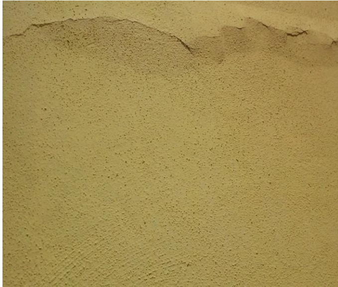
Fig.3.43 - Fissuração da tinta com destacamento total do reboco e película de tinta.
