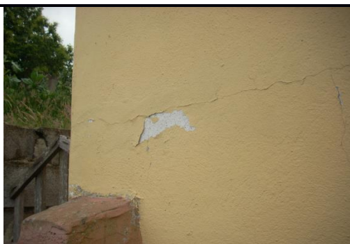
Fig.5.135 - Destacamento do revestimento e fissuras na fachada E2.
