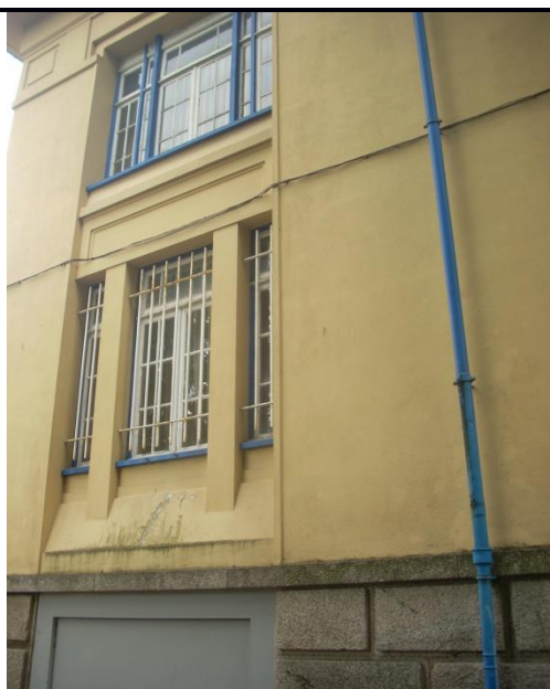
Fig.5.9 - Sujidade, manchas e colonização biológica na fachada N5.
