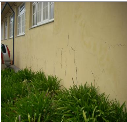
Fig.5.10 - Fissuras, descasque e manchas na fachada S1.
