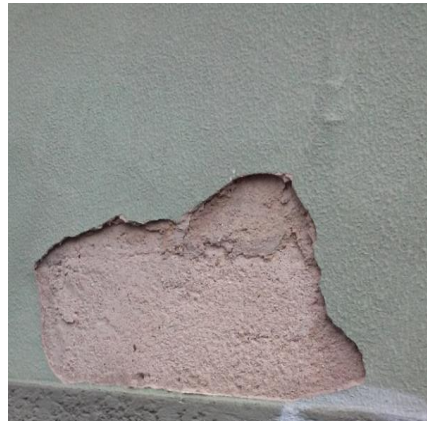
Fig.3.30 - Destacamento de película de tinta e reboco.
