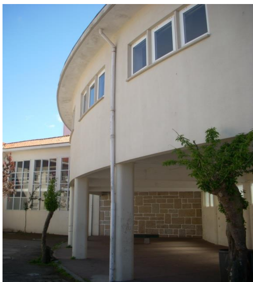
Fig.5.59 - Manchas e saponificação na fachada N2.
