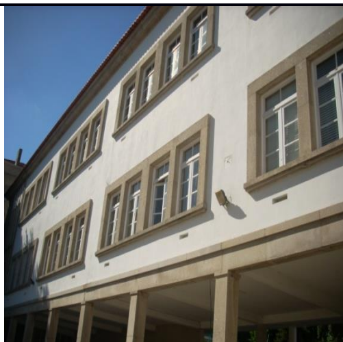
Fig.5.85 - Manchas e sujidade na fachada S.
