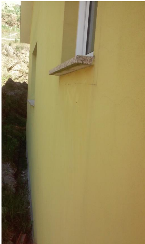
Fig.3.42 - Fissuração sob janela.
