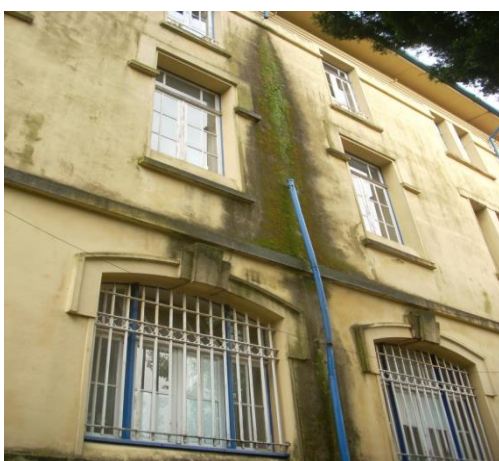
Fig.5.18 - Colonização biológica, descoloração e fissuras na fachada O2.
