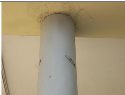
Fig.5.40 - Fissuração e sujidade na fachada O2.
