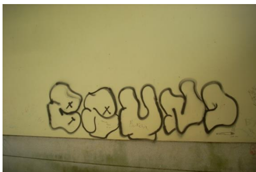
Fig.5.32 - Grafites na fachada E1.
