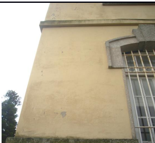
Fig.5.5 - Manchas e fissuração na fachada N3.
