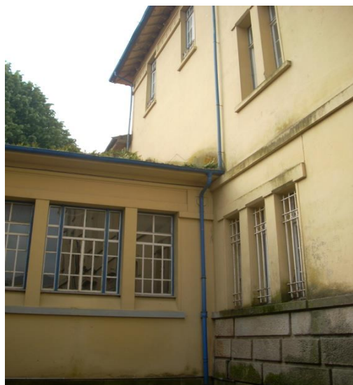
Fig.5.14 - Colonização biológica, fissuras, descoloração e manchas na fachada E1.
