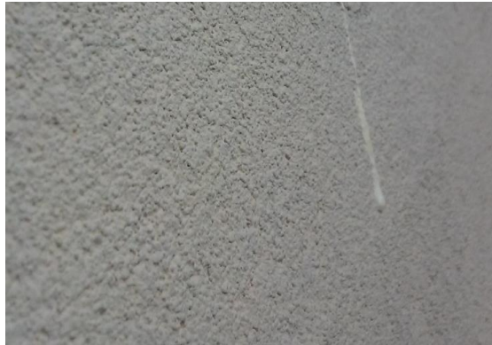
Fig.3.7 - Escorrimento de tinta.
