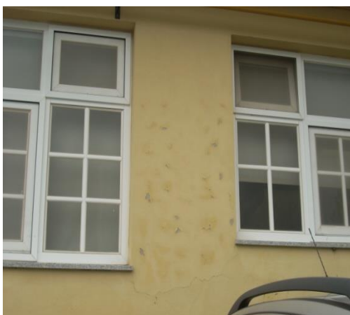
Fig.5.11 - Manchas na fachada S1.
