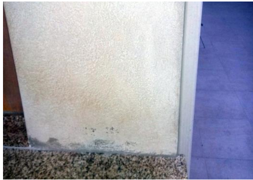
Fig.5.119 - Descasque na fachada E.
