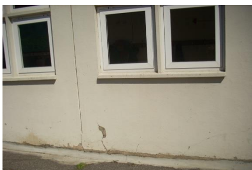
Fig.5.65 - Fissuração, descasque e sujidade na fachada E.
