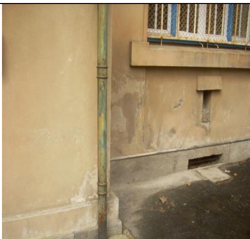
Fig.5.16 - Fissuração, descasque e manchas na fachada E2.
