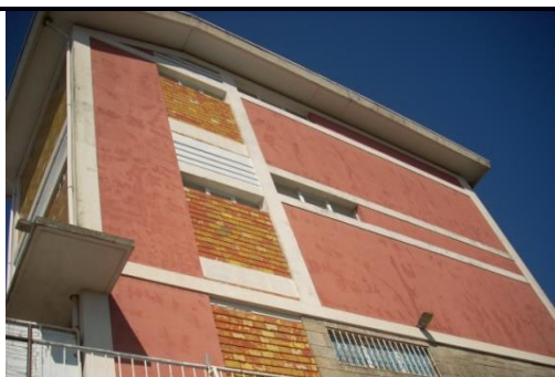
Fig.5.77 - Manchas na fachada S.
