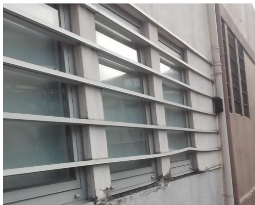
Fig.3.58 - Danos provocados no sistema ETICS por raspão de um veículo.
