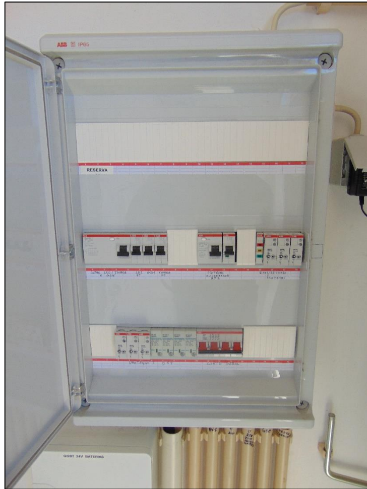
Figura 5.5 - QGBT de serviços auxiliares, Alcoutim 19/05/2015
