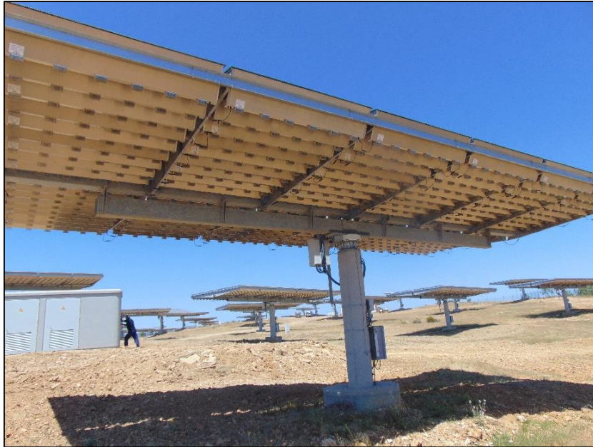
Figura 5.14 - Seguidor solar, Alcoutim 19/05/2015
