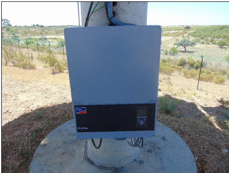
Figura 5.15 - Inversor DC/AC, Alcoutim 19/05/2015
