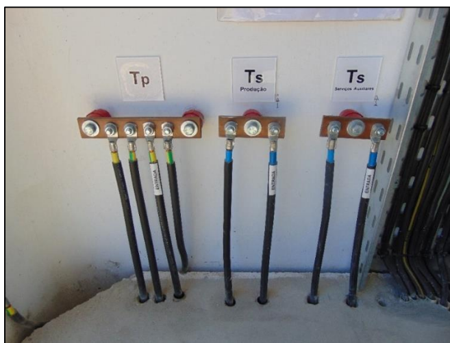
Figura 5.11 - Terras de serviço e proteção, Alcouthim 19/05/2015
