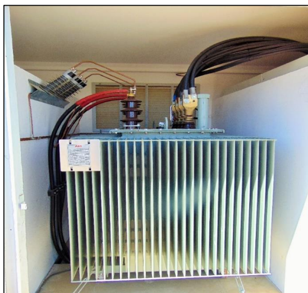
Figura 5.9 - Transformador de 1.25 MVA, Alcoutim 19/05/2015
