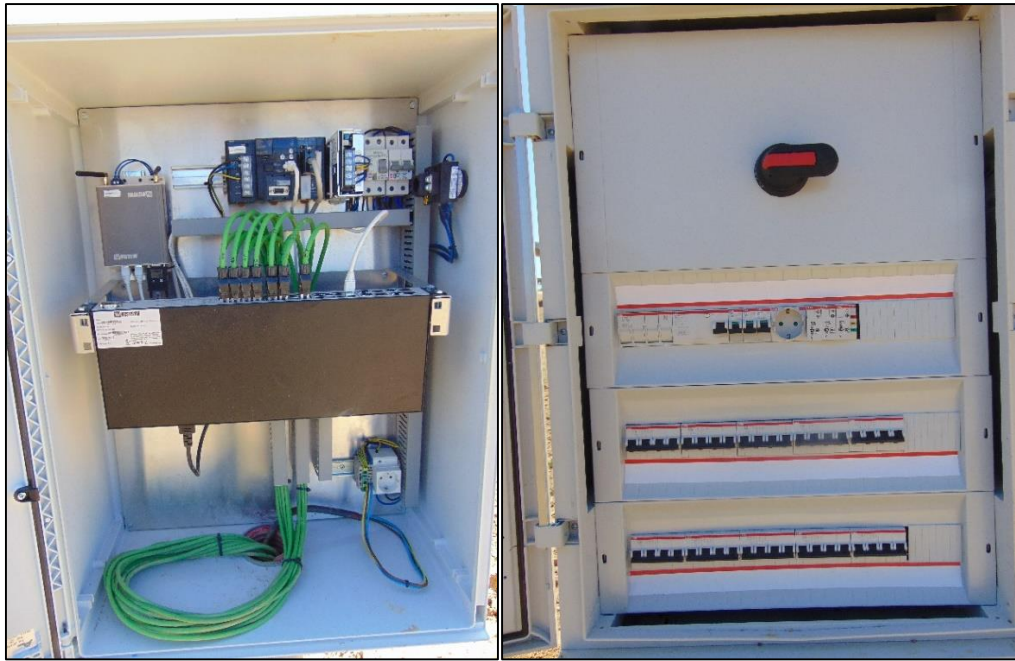
Figura 5.18 - Parte interior do quadro de controlo e quadro parcial, Alcoutim 19/05/2015
