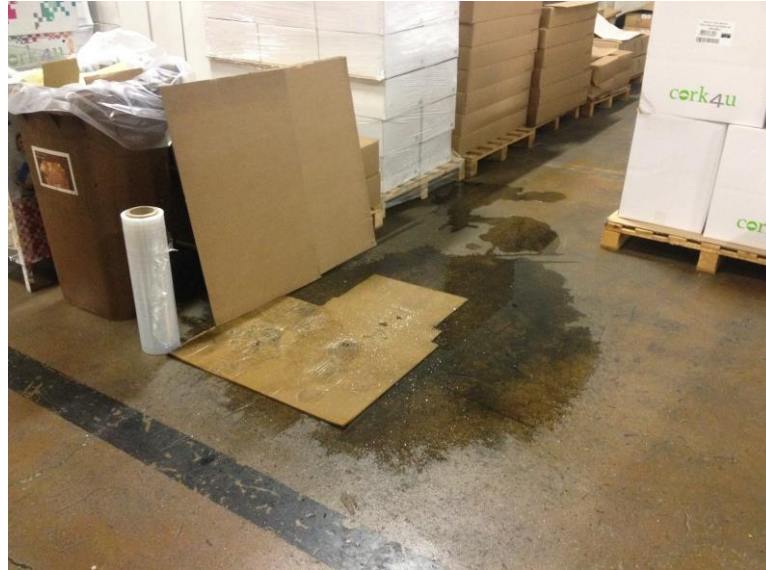
Ilustração 21 - Entrada de água pela cobertura, danifica material
