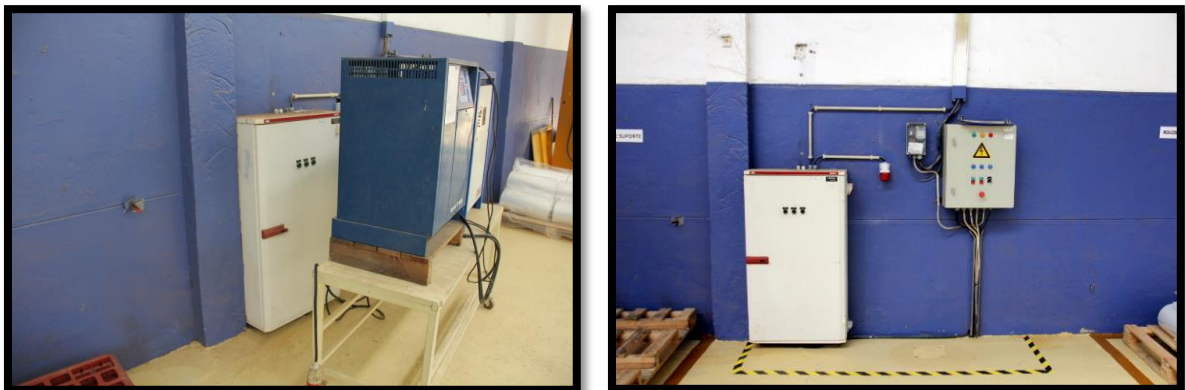
Figura 15. Quadro elétrico obstruído pelo posto de carregamento dos empilhadores.
