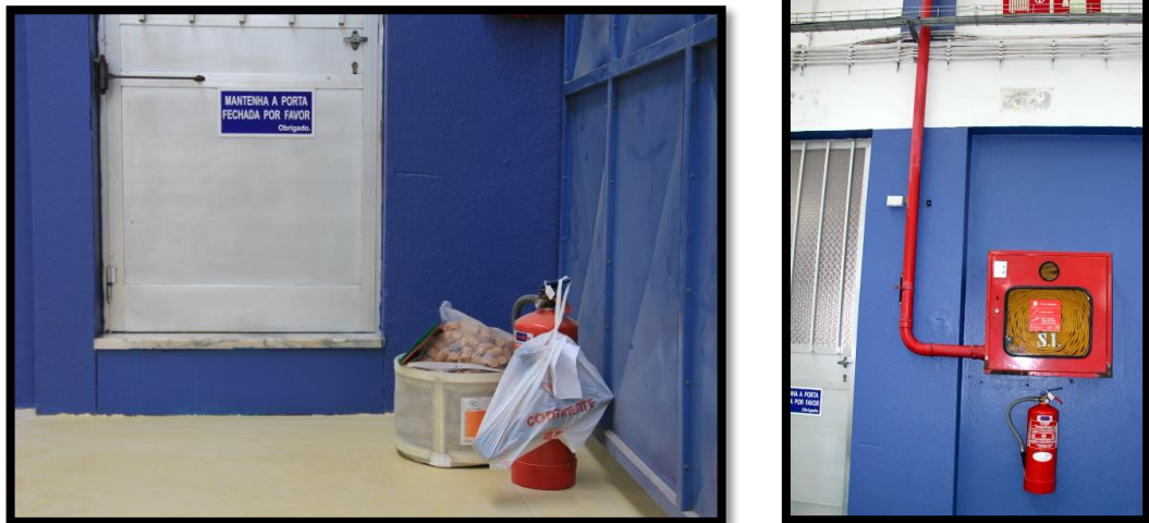
Figura 14. Extintor não colocado e usado como suporte de material.
