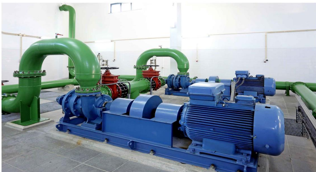
Fig.4.1 – Grupos electrobomba de eixo horizontal da E.E. de São Lourenço
