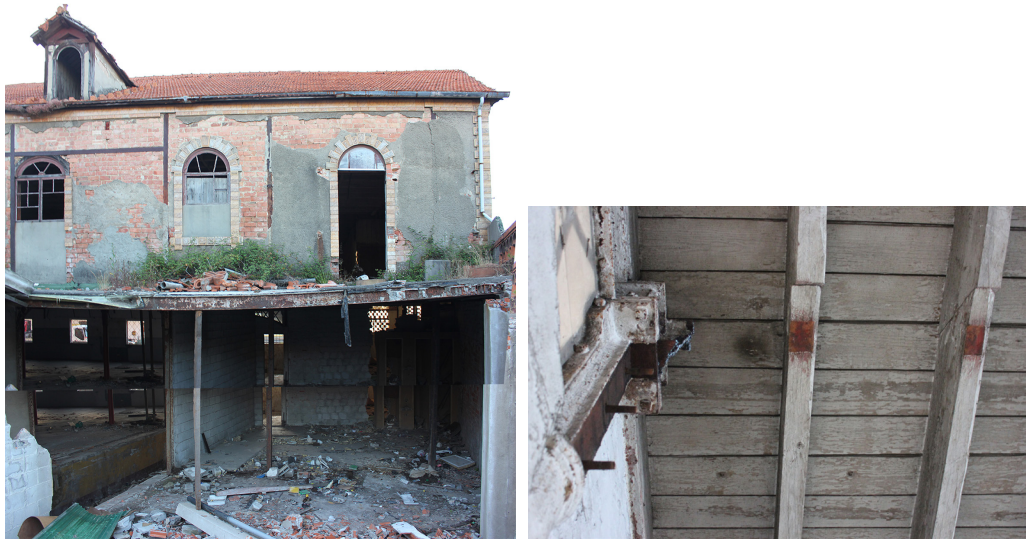
Fig. 93 - Furto de peças e materiais nobres (como o cobre ou o ferro) aceleram o processo de ruína.
