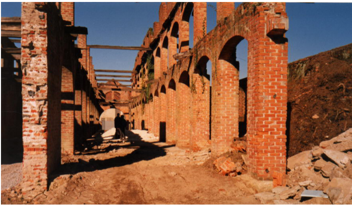
Fig. 60 - Estado de conservação da Fábrica antes da intervenção
