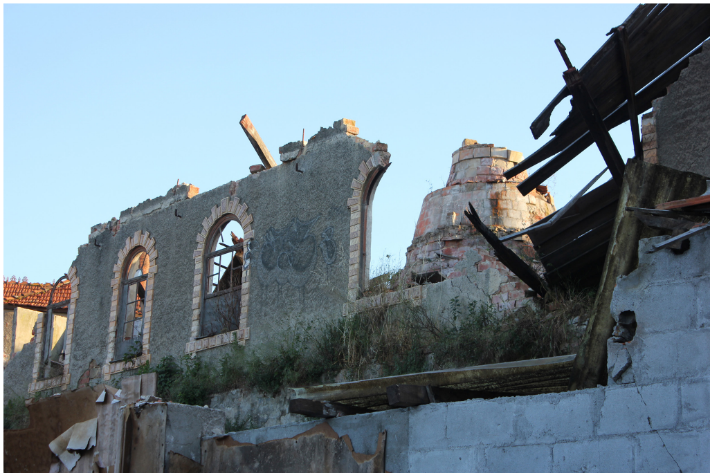
Fig. 94 - Furto de peças e materiais nobres (como o cobre ou o ferro) aceleram o processo de ruína
