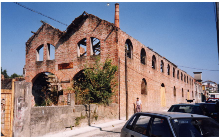
Fig. 61 - Estado de conservação da Fábrica antes da intervenção
