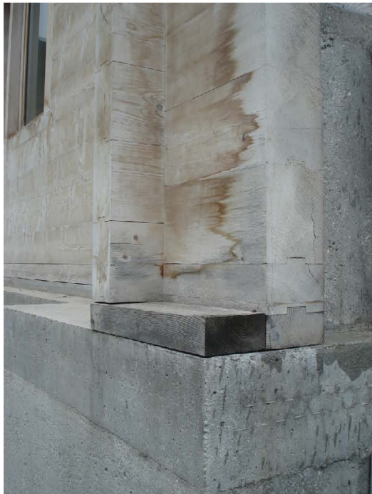
Fig.44 Pormenor da junta da estrutura em madeira com a base em betão.
