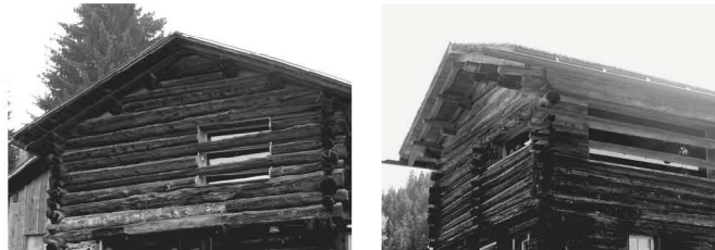
Fig.69 Janelas disfarçadas atrás do revestimento exterior para cumprir a legislação.
