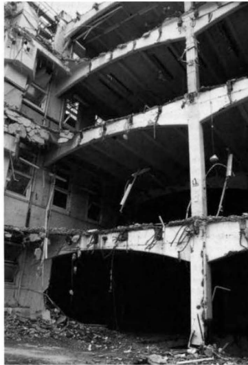
Fig.28 Demolição do edifício dos correios construído segundo o sistema Hennebique, na rua King Edward, Londres, 1998.
