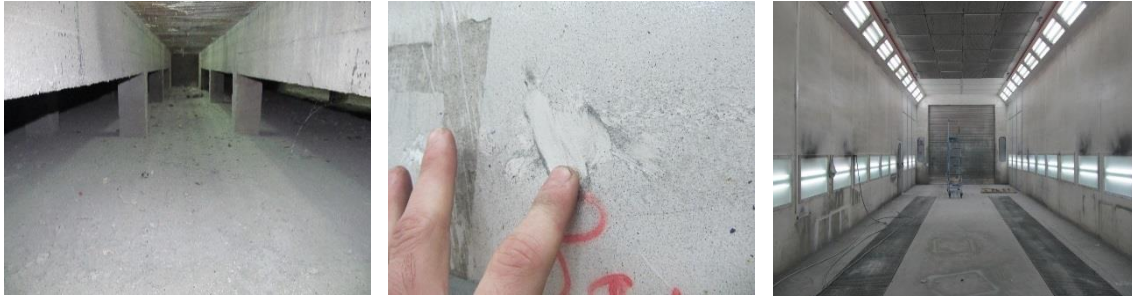
Figura 14 – Poeiras acumuladas na fossa e sujidade geral na cabine de pintura
