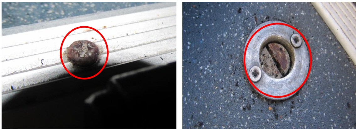
Figura 36 – Parafusos oxidados utilizados no posto dos acabamentos
