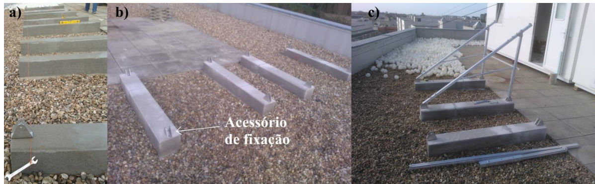
Figura 5.6 - a) Alinhamento dos acessórios de fixação, b) Blocos e respetivos acessórios de fixação e c) Colocação do suporte dos coletores.
