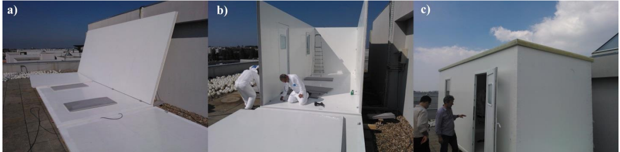
Figura 5.2 - Montagem da TDF em diferentes fases: a) colocação do chão, b) colocação das paredes e c) colocação do teto e porta.
