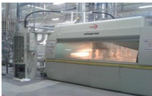
Figura 13: Box de Pintura da L16
