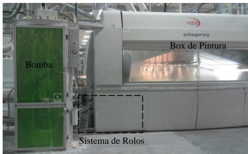
Figura 15: Rotina Manutenção de 1º Nível e indicação dos três locais onde ocorre: Bomba, Box de Pintura e Sistema de Rolos.
