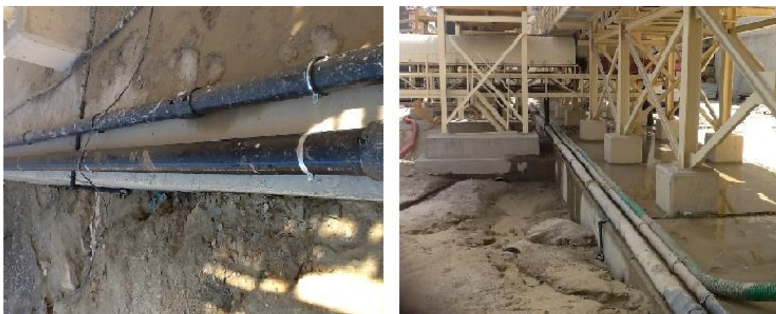
Figura 4.36 - Tubo de transporte de água do Chiller.
