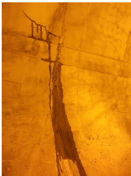
Figura 4.87 – Infiltrações nas juntas de betonagem.
