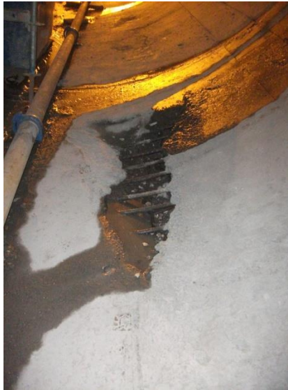
Figura 4.88 - Má execução da betonagem
