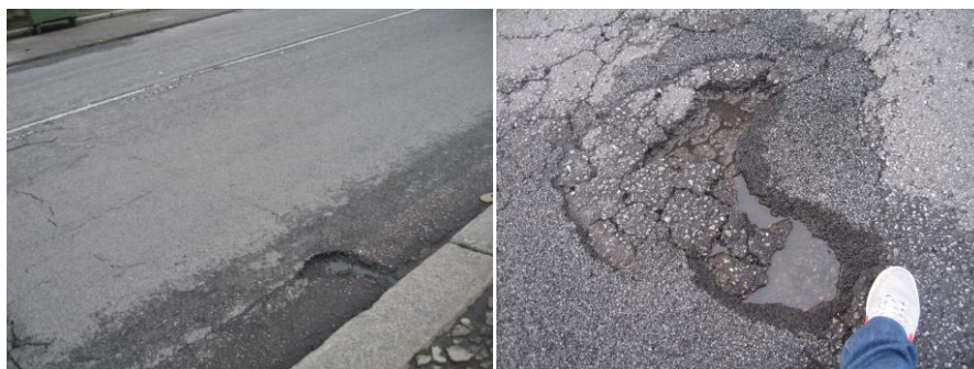
Fig. 4.5. – Av. Paiva Couceiro – Pavimento deteriorado
