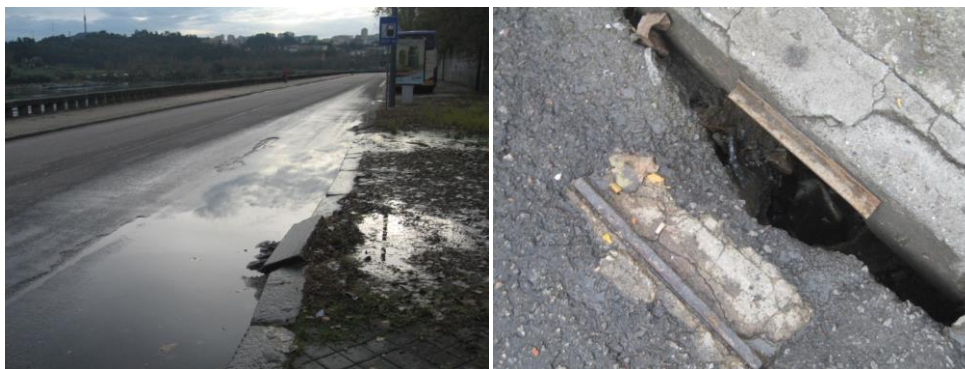
Fig. 4.7. – Av. Paiva Couceiro – Condições de drenagem deficientes
