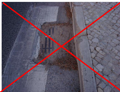
Fig. 3.15. - Exemplo de um sumidouro completamente entupido
