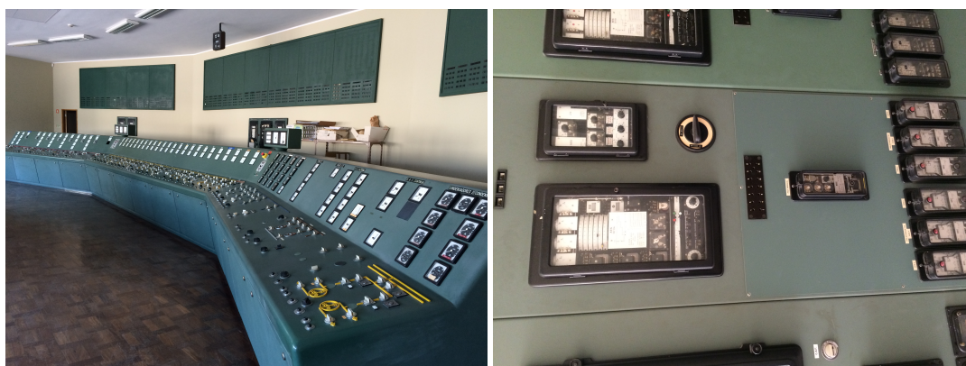
Figura 4.2: Sistemas de Comando e Proteção da subestação de Vermoim antigos
