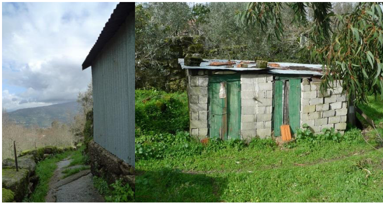
Figura 22 - Estruturas de má qualidade ou em mau estado. (A recuperar ou demolir)
