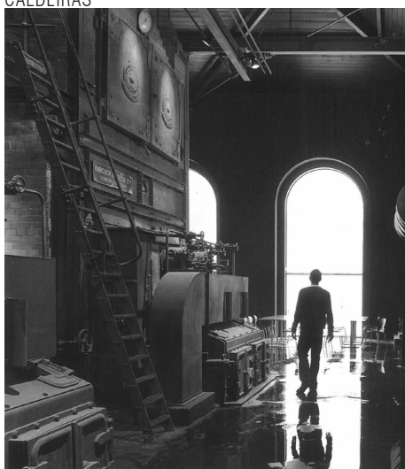
IMG. 73 INTERIOR DA CASA DAS CALDEIRAS
