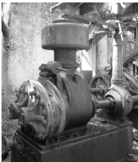
IMG. 51 MÁQUINA DA CENTRAL DO BIEL
