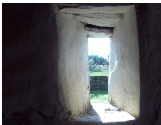
fig. 66- Vão na capela-mor da Igreja de Santo Amaro
