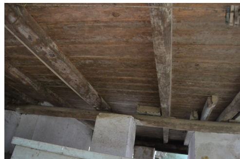
[32c]. Pormenor das vigas sobre os pilares; esta fotografia corresponde à construção 5 no quadro em 3.1.1.
