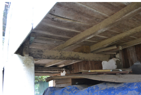
[32e]. Pormenor do reforço sobre o sobrado; esta fotografia corresponde à construção 5 no quadro em 3.1.1.
