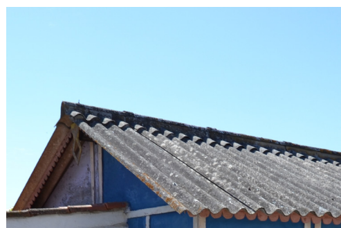
[54b]. As placas de fibrocimento da habitação 12.
