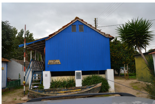
[43d]. No caso da construção 6, a parede exterior Nascente não apresenta ripas mata-juntas.
