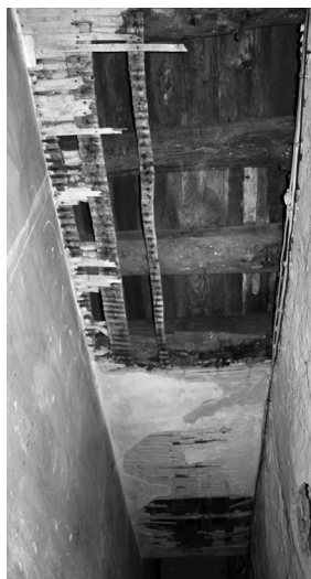
Fig. 116, 117 e 118 Deterioração dos soalhos e dos tectos
