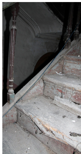
Fig. 130, 131 e 132 Deterioração da caixa de escadas
