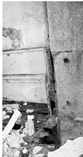
Fig. 127, 128 e 129 Deterioração dos mata juntas dos vãos de sacada
