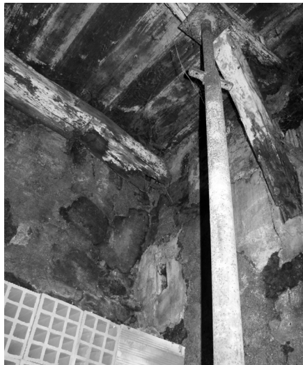
Fig. 114 e 115 Anomalias no apoio das vigas dos sobrados nas paredes
