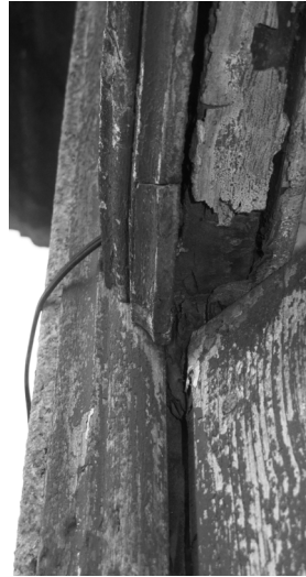
Fig. 124, 125 e 126 Deterioração das folhas das janelas de sacada
