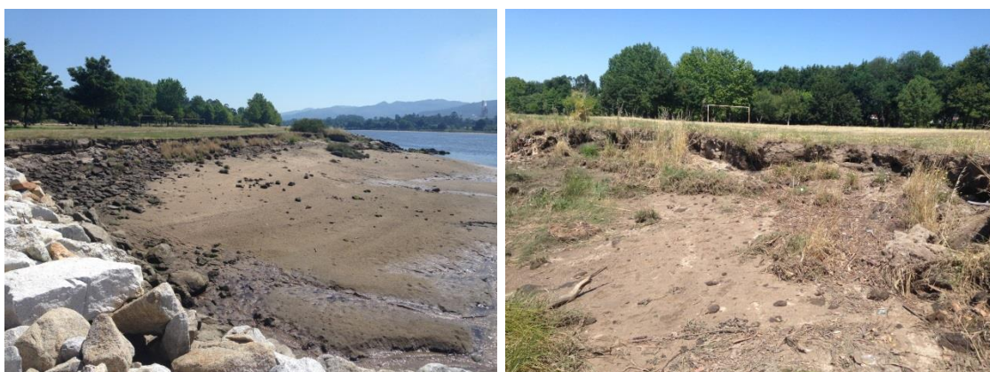
Figura 75 – Erosão da margem direita do rio Lima, pondo em risco a zona de lazer, no troço de Cardielos onde apenas foram instalados esporões (13/06/14).
