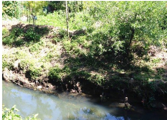
Figura 21 – Faxinas removidas e margem sujeita a erosão no troço do Viso (23/02/14).
