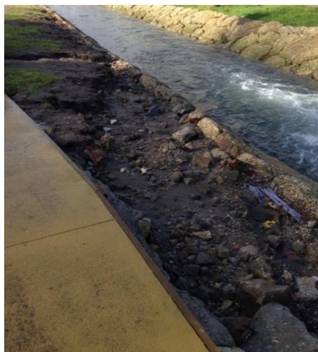
Figura 52 – Situação de erosão na margem esquerda do sub-troço 4 (13/01/14).
