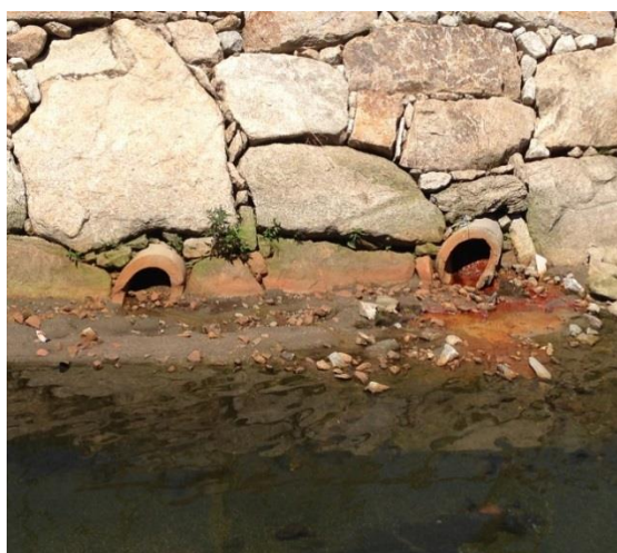
Figura 48 – Escorrência para o rio numa ligação direta de águas pluviais na zona mais a montante do sub-troço 5 (13/06/14).
