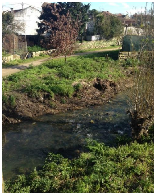
Figura 18 – Erosão da margem esquerda na zona da bacia de retenção no troço do Viso da ribeira da Granja (23/02/14).
