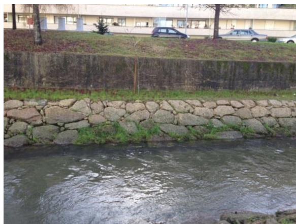
Figura 51 – Desenvolvimento de vegetação no tapete de enrocamento (13/01/2014).
