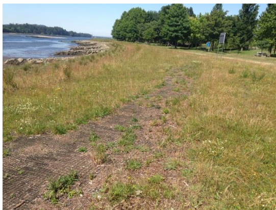
Figura 81 – Área onde a hidrossementeira não desenvolveu no troço de Cardielos (13/06/14).
