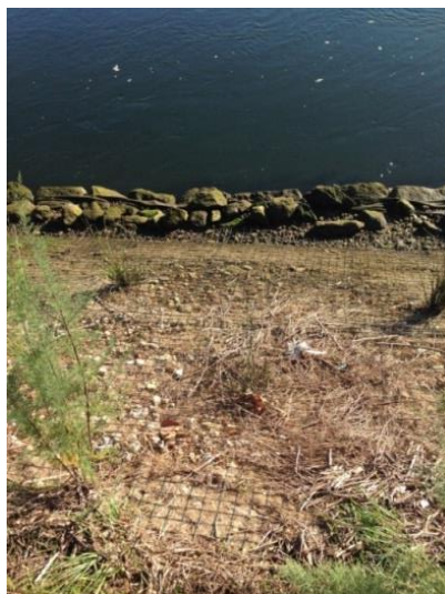
Figura 84 – Rede de malha metálica de proteção da camada de terra vegetal visível no troço de Portuzelo (14/11/13).
