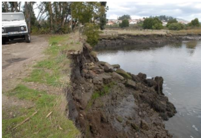
Figura 67 – Situação pré-intervenção (março de 2011) de instabilidade da margem direita do rio Lima no troço de Portuzelo (cedido pela CmV).
