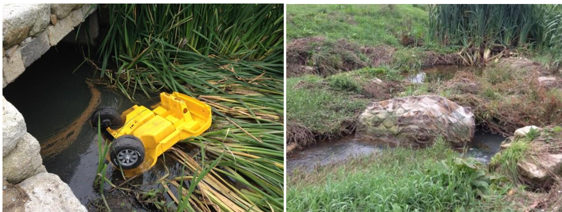
Figura 26 – Presença de entulhos no leito da ribeira da Granja no troço da Quinta do Rio (15/10/13).
