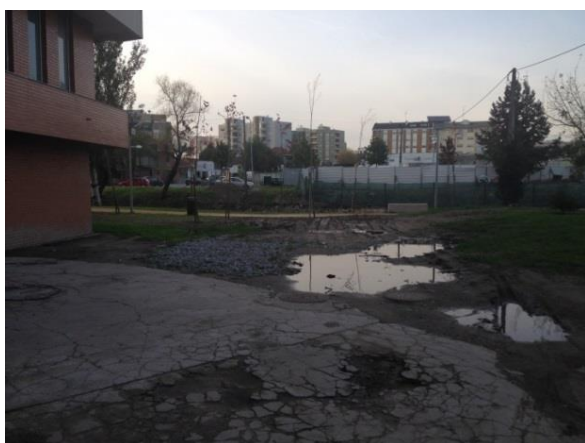
Figura 58 – Acesso à malha urbana em mau estado de conservação no sub-troço 5 (29/10/13).
