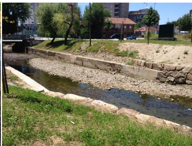
Figura 53 – Acumulação de sedimentos na zona mais a jusante do sub-troço 5 (13/06/14).
