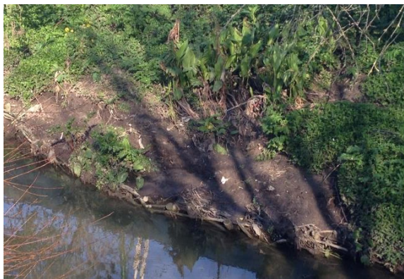
Figura 20 – Faxinas deslocadas da posição vertical em que foram colocadas, na margem esquerda do troço do Viso (23/02/14).
