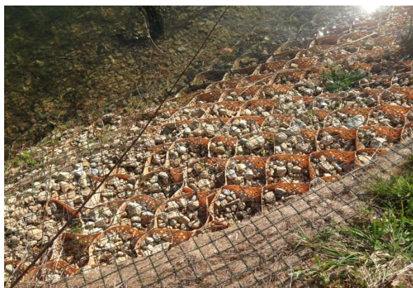
Figura 85 – Manta de geocélulas visível no troço de Portuzelo, devido a arrastamento do seu preenchimento pelo caudal do rio (18/03/14).
