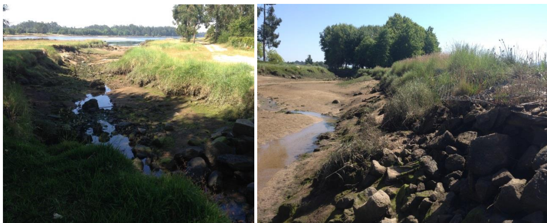
Figura 77 – Erosão da margem esquerda do afluente do rio Lima, na extremidade mais a jusante do troço intervencionado de Cardielos (13/06/14).
