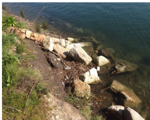
Figura 86 – Estruturas de proteção da margem desprotegidas nos limites laterais no troço de Portuzelo (18/03/14).
