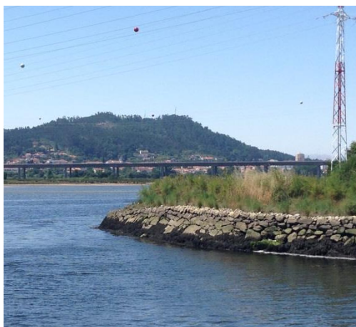
Figura 87 – Altura descontinuada da camada de enrocamento (13/06/14).
