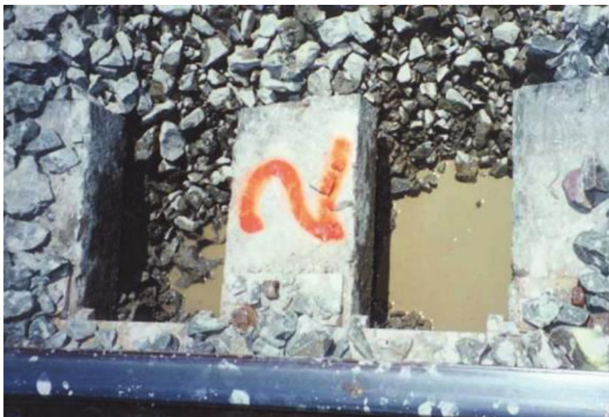
Figura 8 – Acumulação de água à superfície causada por condições de drenagem insuficientes (Indraratna et al. , 2011).
