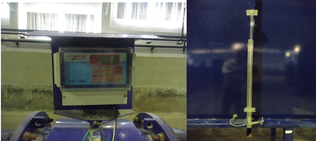
Figura 3.6 – Dispositivo de medição de caudal e piezómetro
