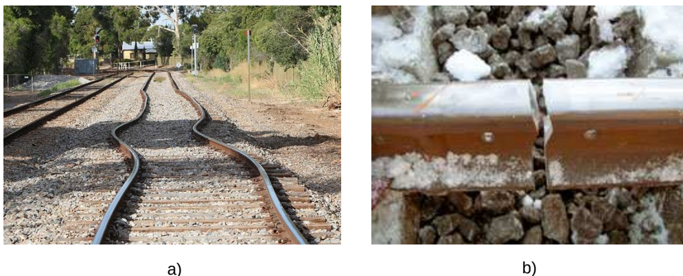
Figura 2.1 - Mecanismos de rotura: a) Encurvadura da via; b) Rotura do carril.
