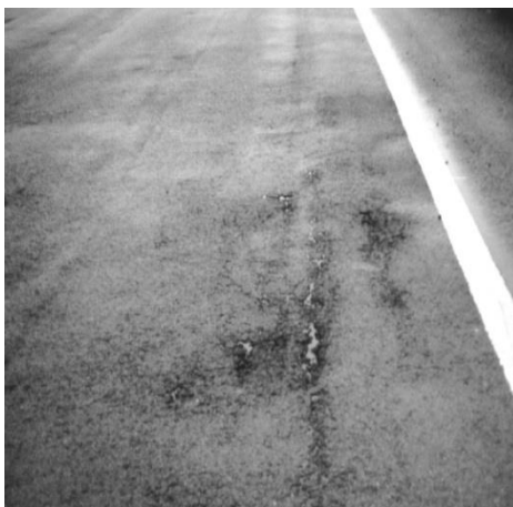
Fig.2.8 - Superfície de pavimento degradada [13]
