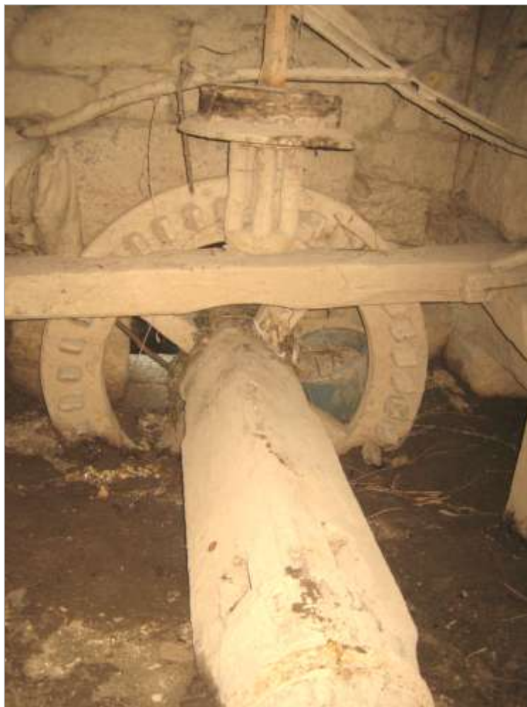
Fig.10. Sistema motor da roda de água a jusante
