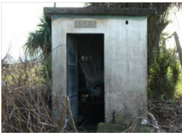
Fig. 153. Motor de elevação da água do poço. Data 1956
