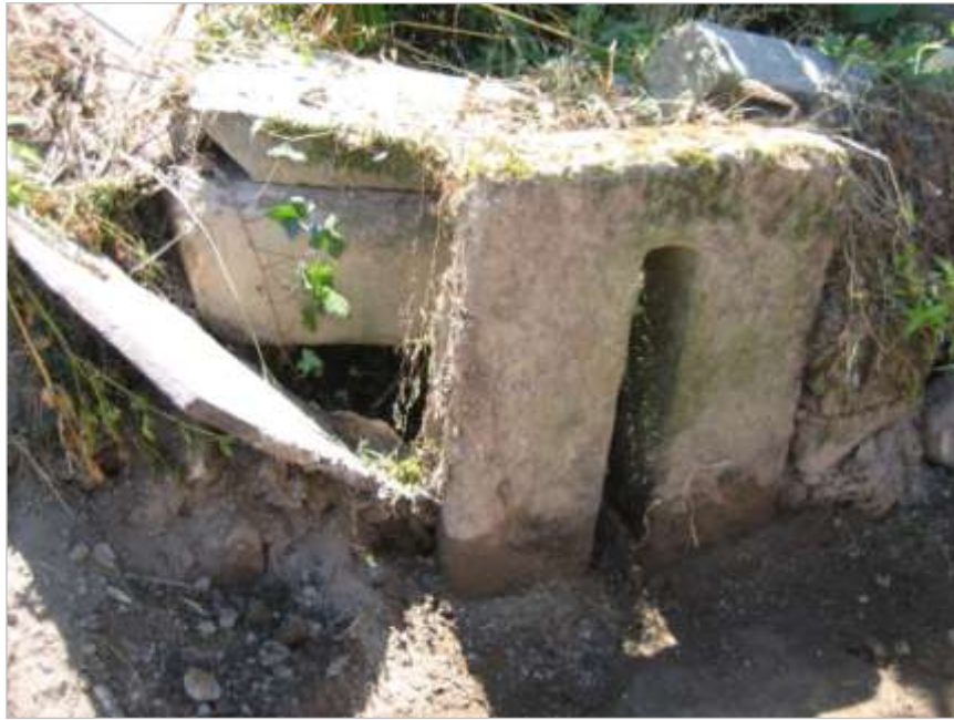
Fig.30. Registro de rega arruinado
