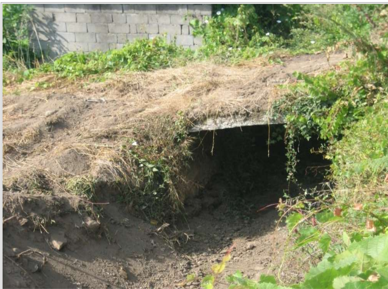
Fig. 39. Pontilhão destruído no ano de 2011.
