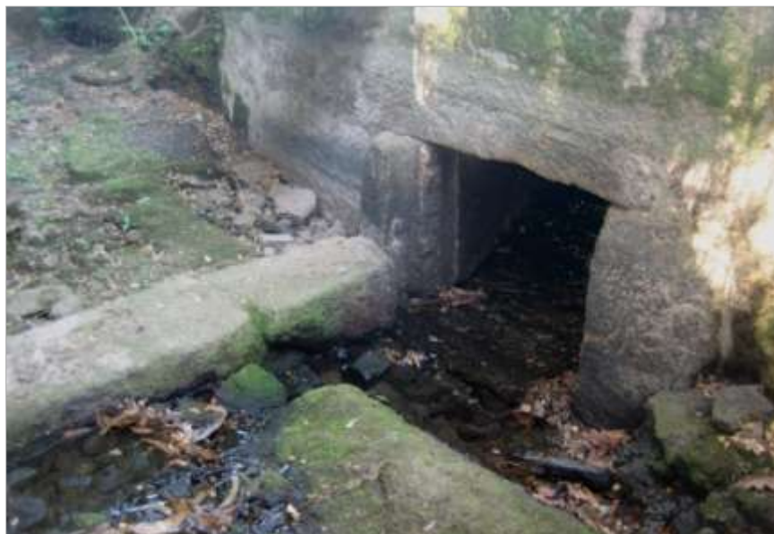
Fig.37. Boca do canal de drenagem a jusante do açude da Borrallheira, Nine
