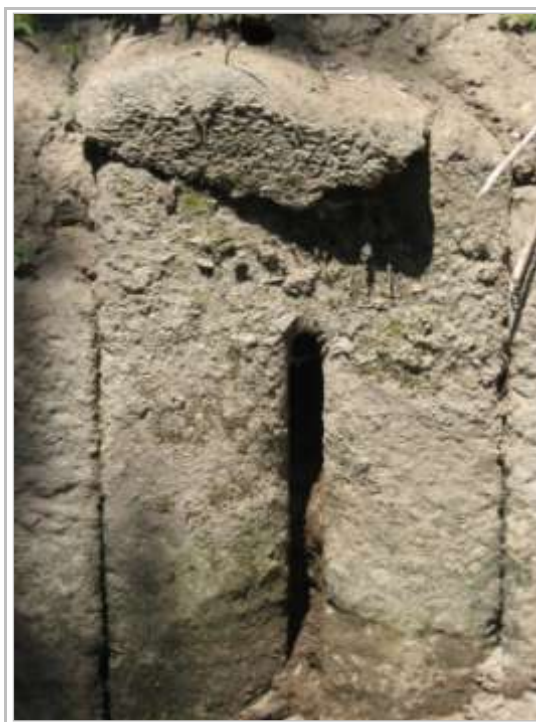
Fig. 82. Registro de lima fraturado e desativado.
