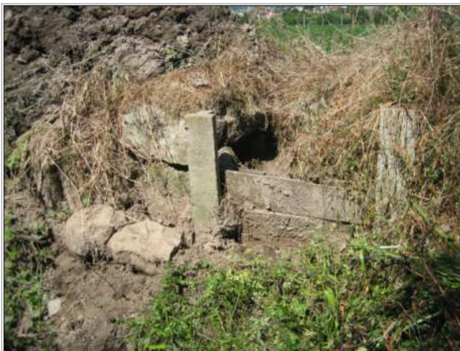
Fig. 75. Registo degradado com a cobertura abatida no interior. Junho de 2011
