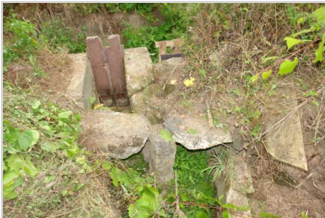
Fig. 134 e 135. Estrutura interna do registo e comportas.
