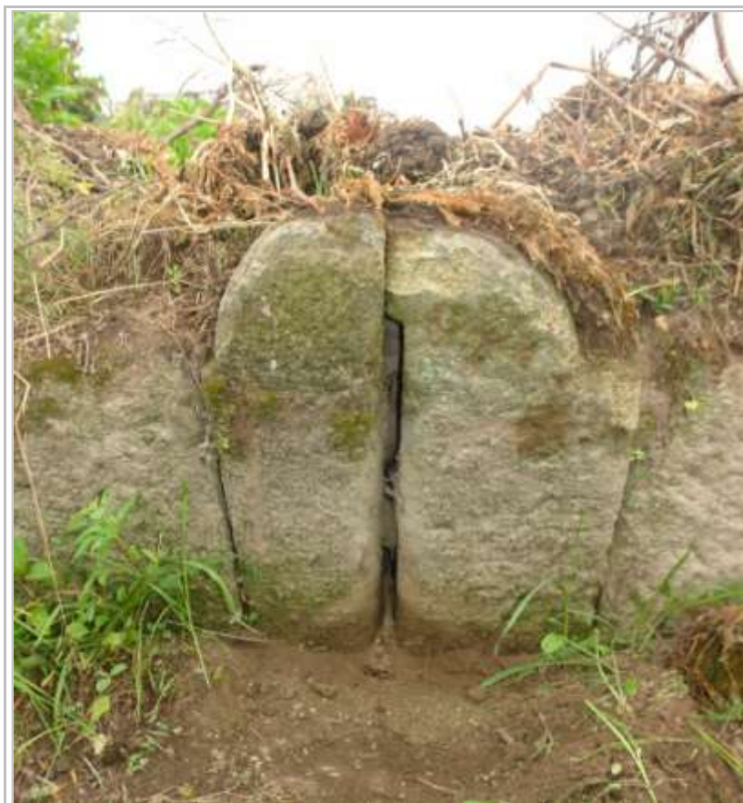
Fig.114. Exemplo dos estragos provocados nestas estruturas pela mecanização das limpezas. Fotos de Junho de 2011
