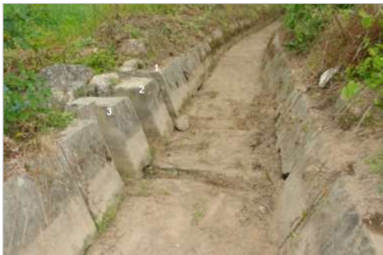
Fig. 137. Registo e canal cimentado. Lugar da Corredoura, Nine.
