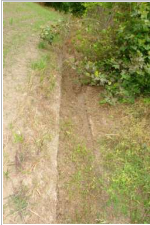
Fig.62. Troço final em meio cano de cimento que desagua no rio Este. Lugar da Estação, Nine
