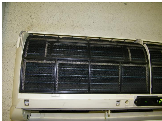
Figura 5.13 - Split unidade interior, verificação de filtros
