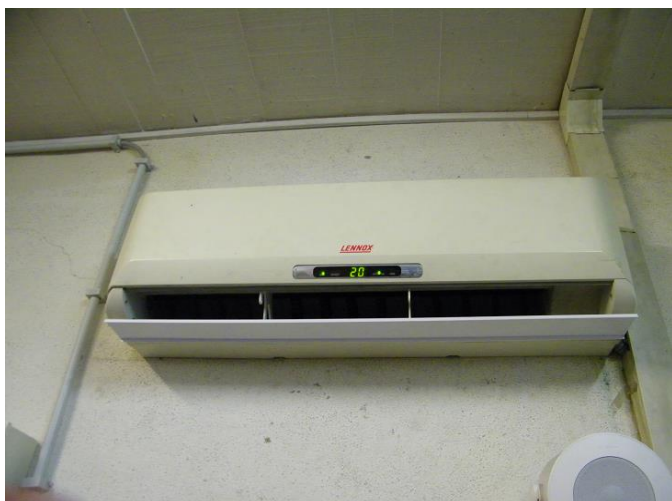
Figura 5.12 - Split unidade interior
