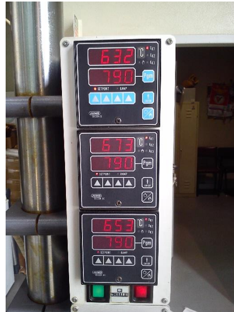
Figura 14- Controladores dos termopares
