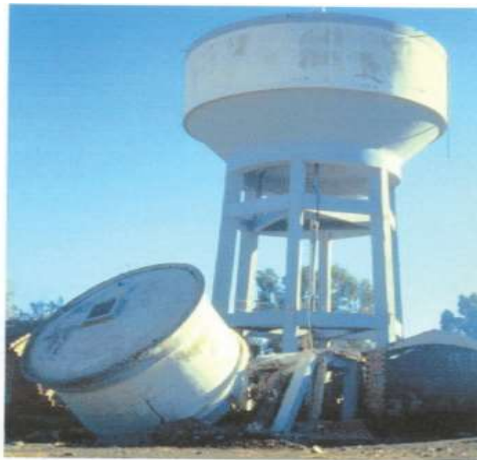
Figura 2 - Colapso do tanque elevado de água devido ao terremoto em El-Asnam na Argélia em 1980 [23].
