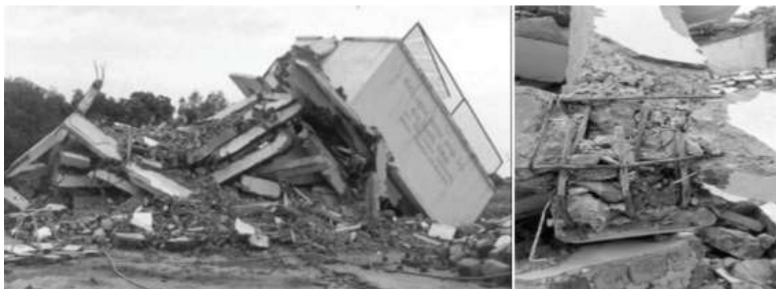
Figura 5 - Colapso associado a grande esbelteza e fragilidade estrutural da obra de arte em Manfera Village [23].
