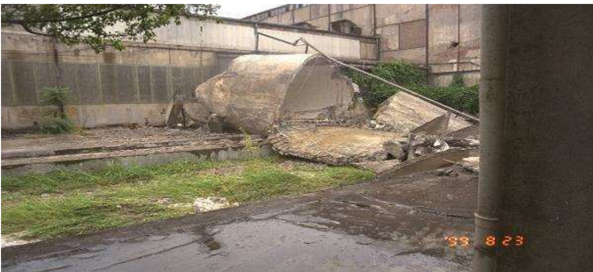
Figura 1 - Colapso de tanque elevado durante o sismo de Kocaeli [21].
