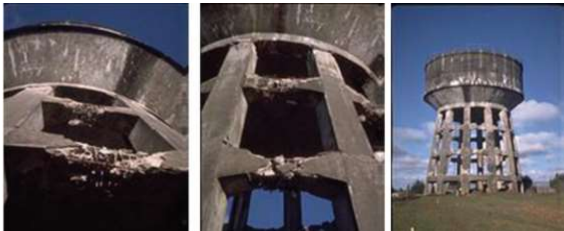
Figura 7 - Danos ocorridos num tanque elevado de água com capacidade de 700m 3 [24].
