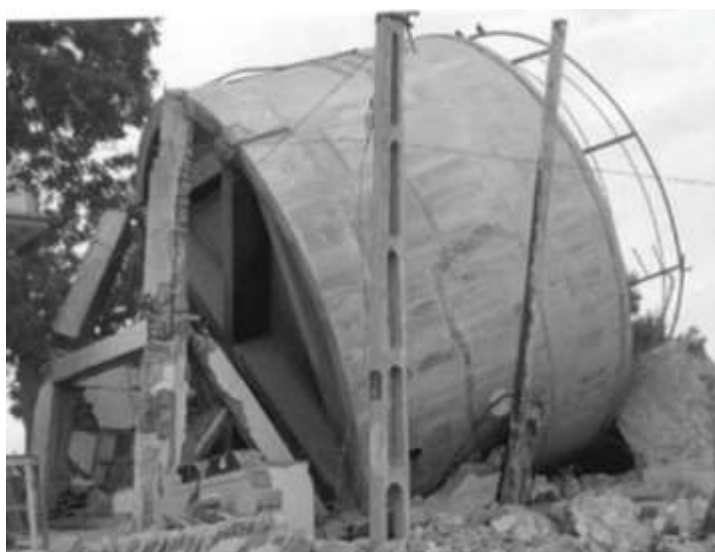
Figura 6 - Colapso de tanque elevado em Bhachau, Índia [24].
