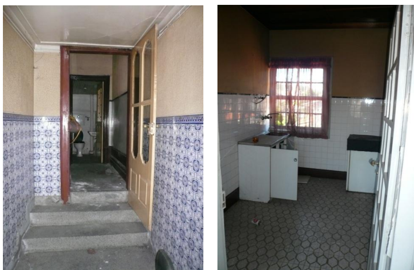
Figura 5.8 – Degraus de acesso à escadaria (à esquerda) e cozinha pré-existente (à direita)
