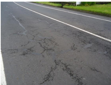
Fig. 3.2.8. – Sentido Decrescente, Fissuras Ramificadas com desagregação e alguma selagem em toda a via direita entre os PK's [6+383 – 6+434]. [Extraída da Inspeção Visual do pavimento realizada em 16/04/2014]
