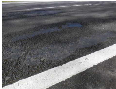
Fig. 3.2.4. – Sentido Crescente, Muita desagregação e selagem em toda a via entre os PK's [5+202-5+207]. [Extraída da Inspeção Visual do pavimento realizada em 15/04/2014]
