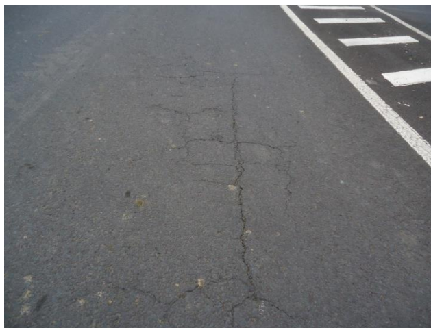
Fig.2.3. – Ilustração de uma fenda longitudinal ramificada acompanhada de alguma desagregação. [Extráida de Inspeção Visual a um pavimento rodoviário realizada em 14/04/2014]
