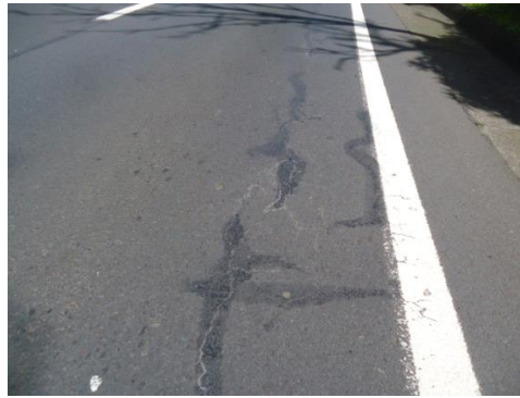
Fig. 3.2.2. – Sentido Crescente, Fissura Longitudinal a ramificar com subida de finos e selagem no rodado direito da via direita entre os PK's [1+122 - 1+158]. [Extraída da Inspeção Visual do pavimento realizada em 14/04/2014]
