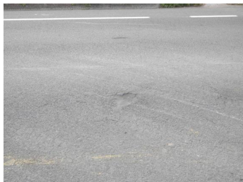
Fig. 3.2.5. – Sentido Crescente, Ninho no rodado esquerdo da via direita ao PK 6+033. [Extraída da Inspeção Visual do pavimento realizada em 15/04/2014]
