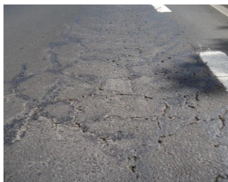
Fig. 3.2.1. – Sentido Crescente, “Pele de Crocodilo” com desagregação, subida de finos e selagem no rodado direito da via direita entre os PK's [0+555 - 0+572]. [Extraída da Inspeção Visual do pavimento realizada em 14/04/2014]
