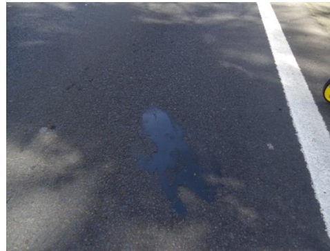
Fig 3.2.3. – Sentido Crescente, Exsudação no rodado direito da via direita ao PK 1+568. [Extraída da Inspeção Visual do pavimento realizada em 14/04/2014]
