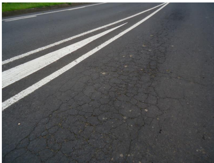
Fig.2.4. - Fendilhamento tipo “Pele de Crocodilo”, nível 3. [Extráida de Inspeção Visual a um pavimento rodoviário realizada em 14/04/2014]
