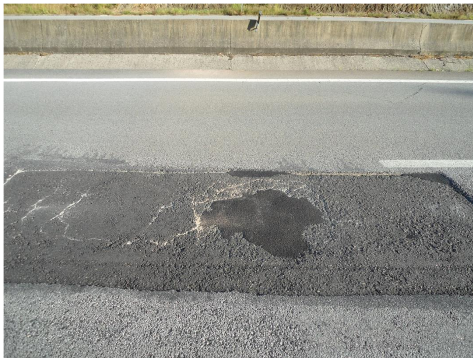
Fig.2.6. - Ilustração de um remendo de nível 3. [Extráida de Inspeção Visual a um pavimento rodoviário realizada em 03/06/2013]
