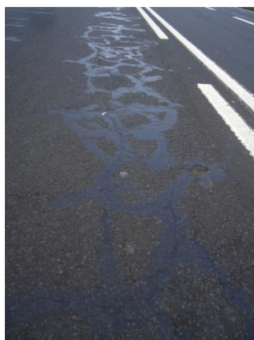
Figura 3.2.6. – Sentido Decrescente, Fissuras Ramificadas, no rodado esquerdo da via direita com alguma desagregação e selagem entre os PK's [0+172 – 0+212]. [Extraída da Inspeção Visual do pavimento realizada em 16/04/2014]
