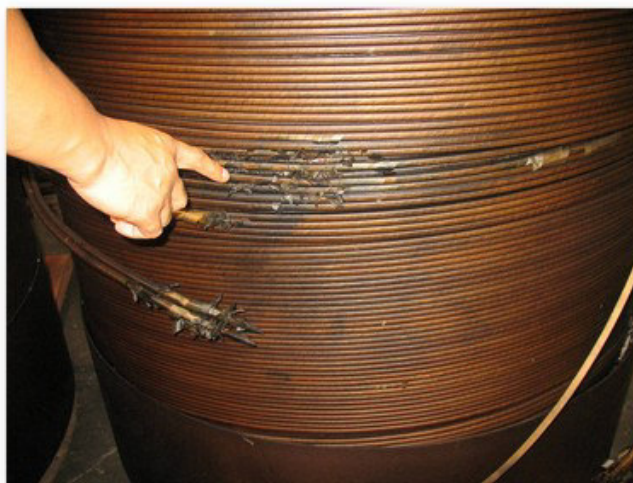
Figura 3.4: Degradação do papel por avaria nos enrolamentos do transformador [18]
