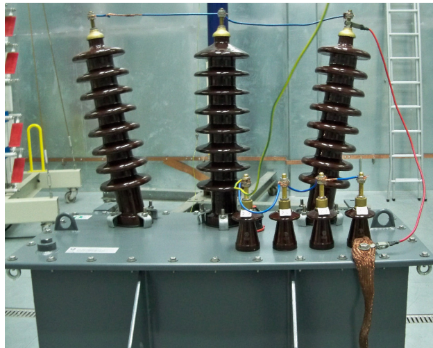
Figura 6.5: Montagem do ensaio para o lado de Baixa Tensão
