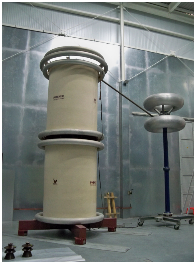
Figura 4.8: Sistema de frequência industrial: à esquerda o transformador e à direita o divisor de tensão
