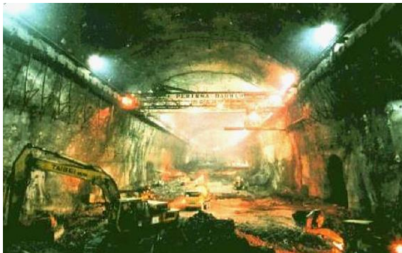
Figura 2.15 - Vigas ancoradas aos hasteais da caverna da central hidroelétrica de Cirata, na Indonésia adaptada de [2].
