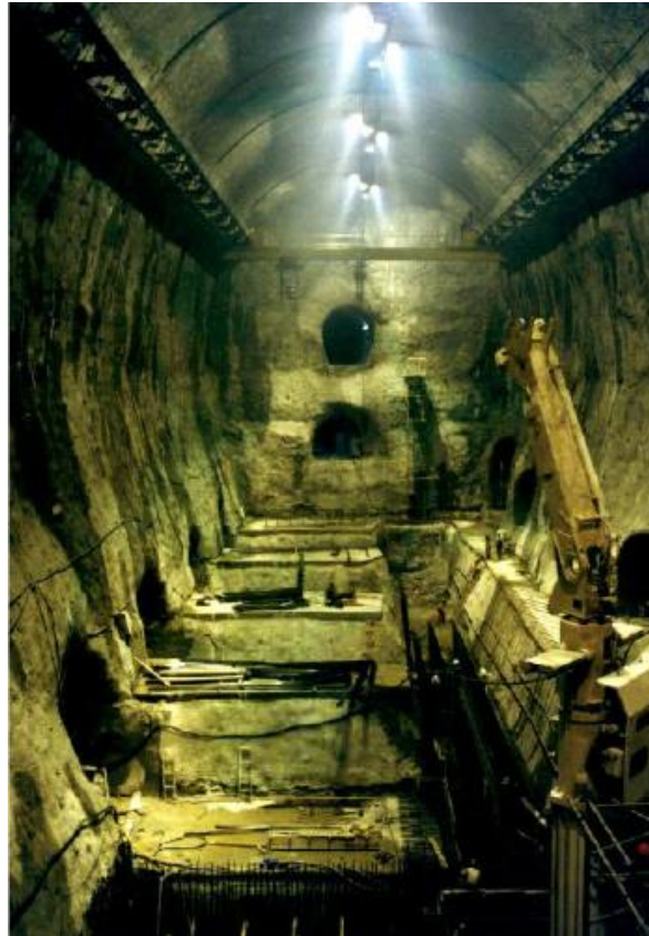
Figura 2.14 - Vigas ancoradas aos hasteais da caverna da central hidroelétrica de Singkarak, na Indonésia; adaptada de [5]
