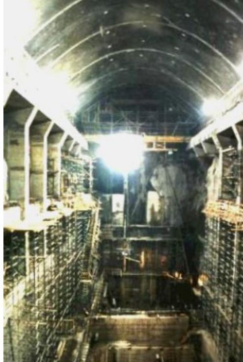
Figura 2.13 - Fase final da construção das colunas de apoio das vigas de caminhos de rolamentos da central de Thissavros; adaptada de [2]
