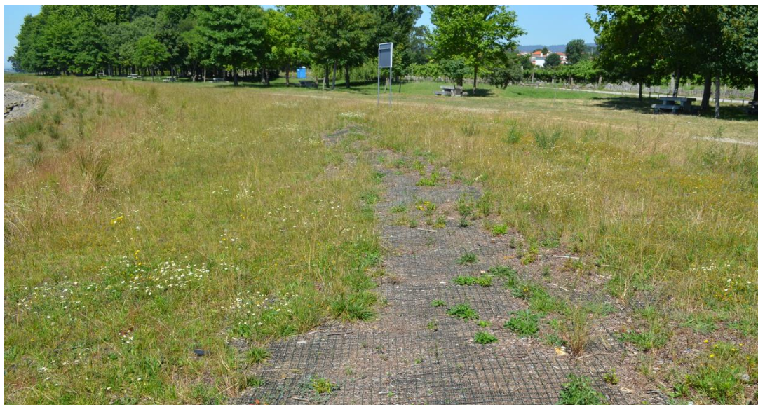
Figura 47 – Hidrossementeria com falhas no troço de Cardielos (Junho, 2014)
