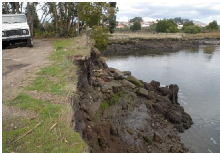
Figura 22 – Instabilidade do talude marginal antes da intervenção de reabilitação no troço de Portuzelo (Cortes et al , 2011)
