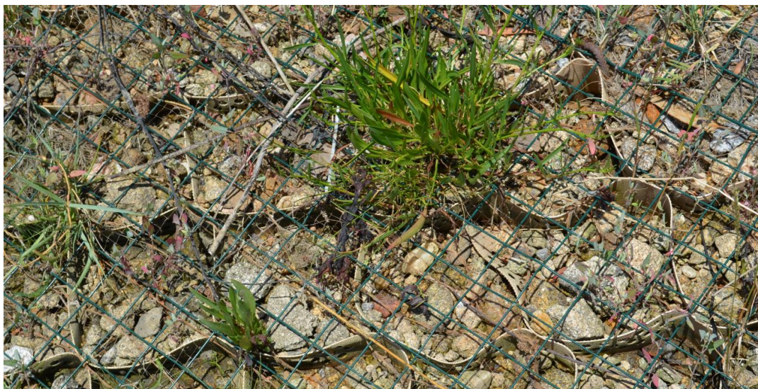
Figura 33 - Rede metálica exposta no troço de Portuzelo (Junho 2014)
