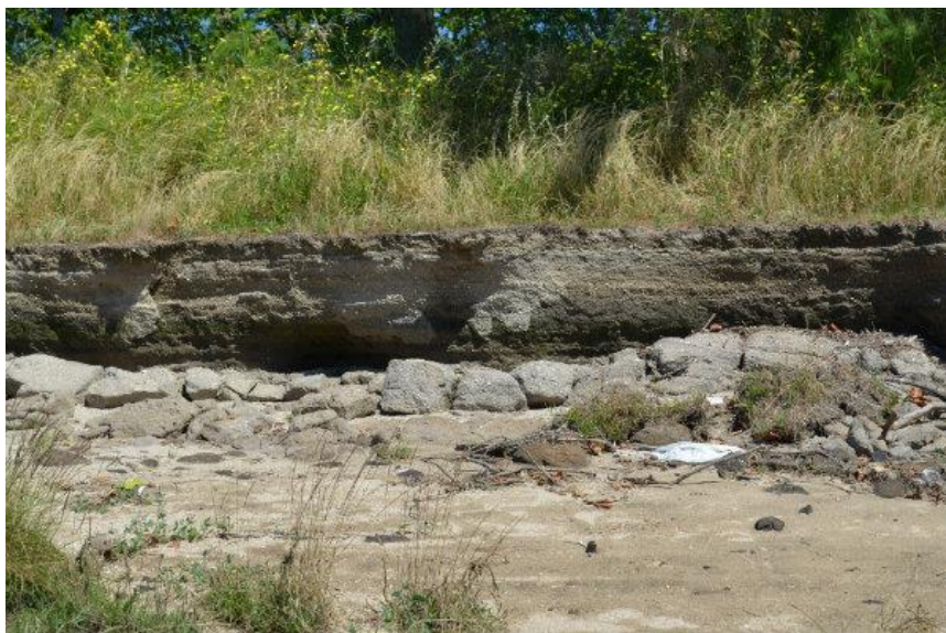
Figura 44 – Estratificação do talude marginal no troço de Cardielos
