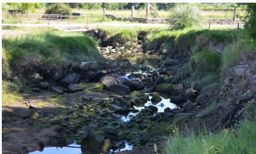
Figura 50 – Danos no canal do afluente ao rio Lima no troço de Cardielos
