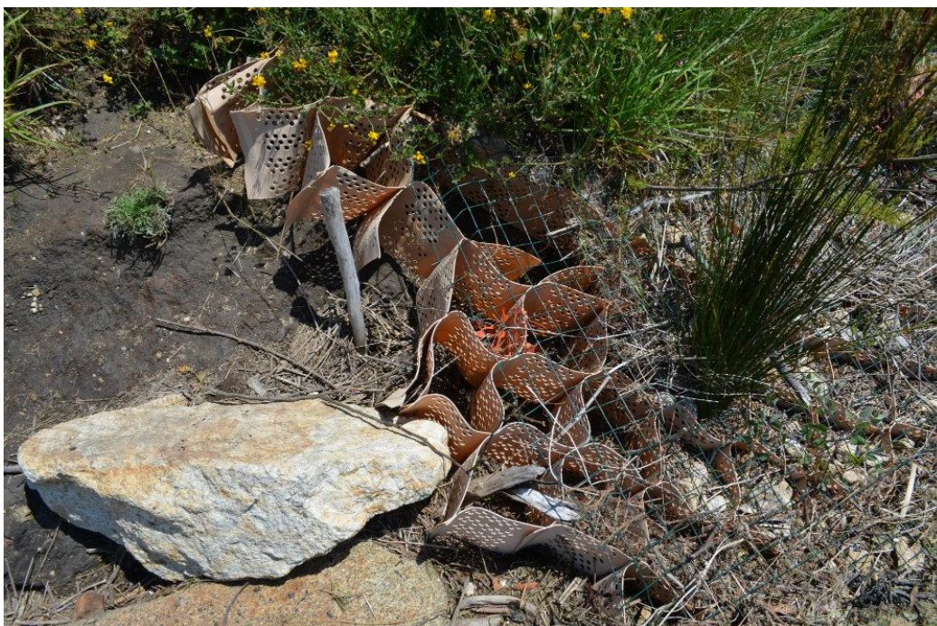
Figura 32 – Comportamento ineficiente da rede metálica, geocélulas e seus constituintes (Junho 2014)
