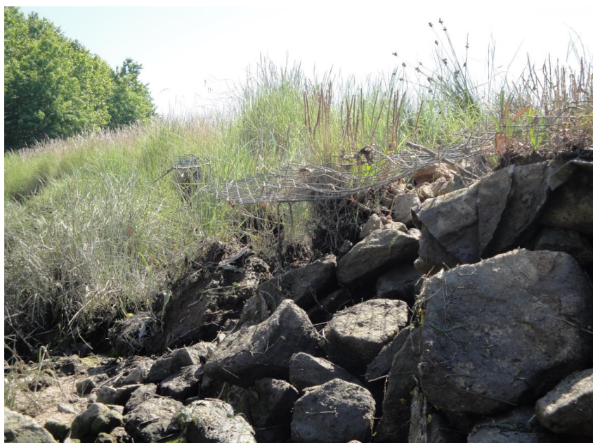
Figura 51 – Rede metálica danificada na reabilitação de Cardielos
