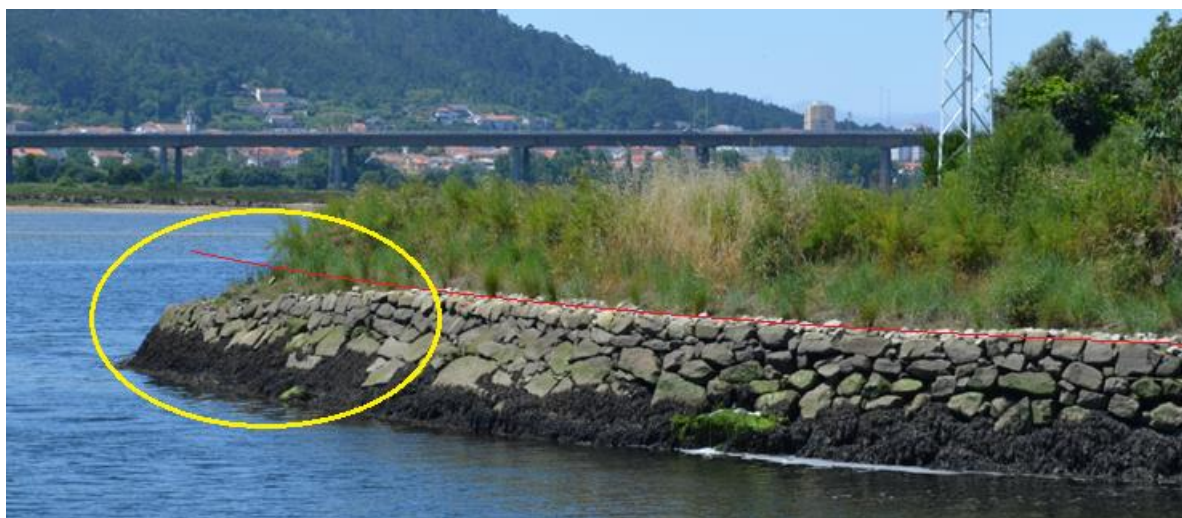
Figura 28 – Altura desnivelada dos blocos de enrocamento (Junho, 2014)
