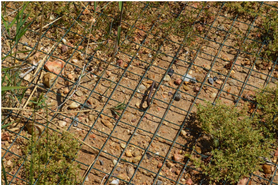
Figura 49 – Rede metálica exposta no troço de Cardielos (Junho, 2014)
