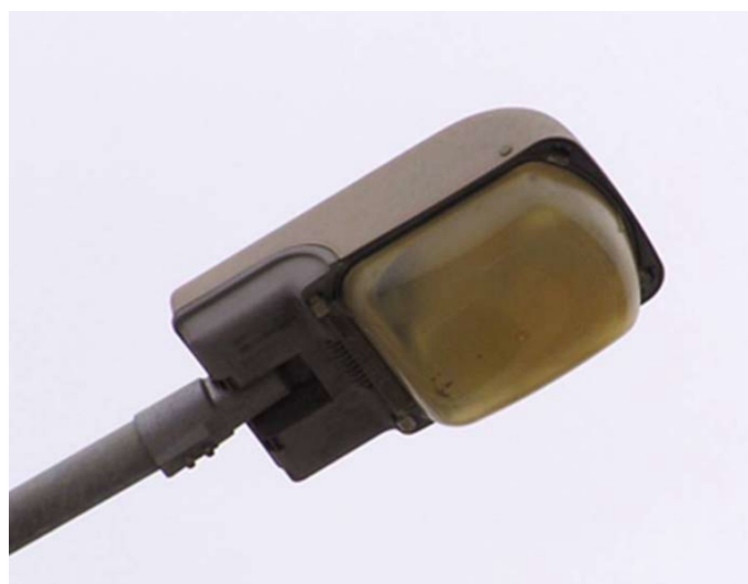
Figura 6.41: Exemplo de difusor danificado [2].
