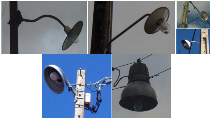
Figura 6.36: Exemplos de luminárias ineficientes utilizadas na IP em Portugal [41].
