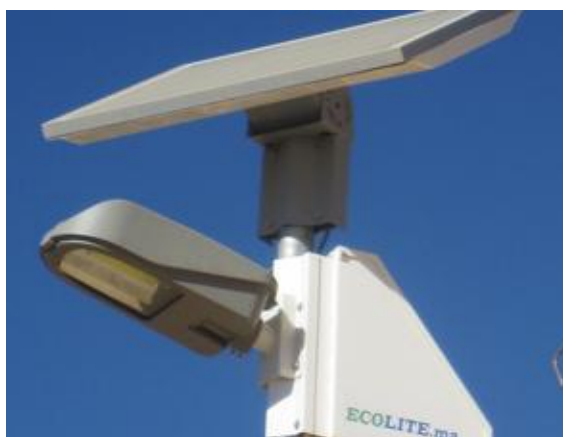
Figura 6.13: Luminária LED alimentada a energia solar em Marrocos [68].
