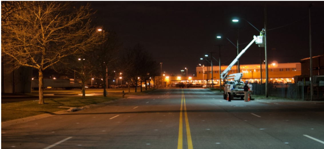
Figura 6.7: Substituição de lâmpadas convencionais de HPS por luminárias LED [43].
