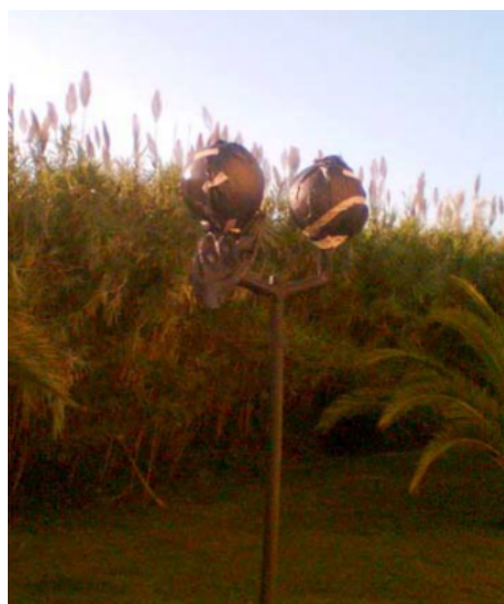
Figura 6.39: Exemplo de luminárias obstruídas por objectos estranhos [2].
