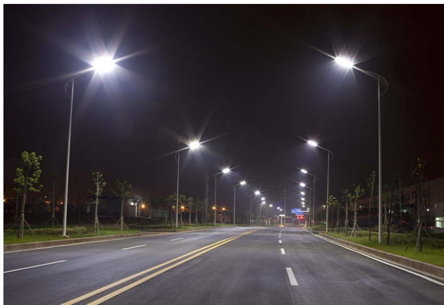
Figura 4.26: Via pública iluminada por tecnologia LED [39].
