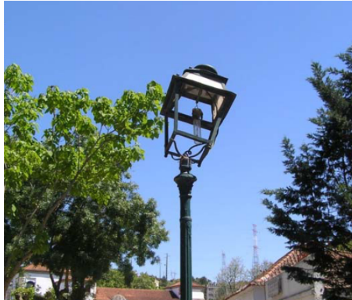
Figura 6.42: Exemplo de luminária vandalizada [2].
