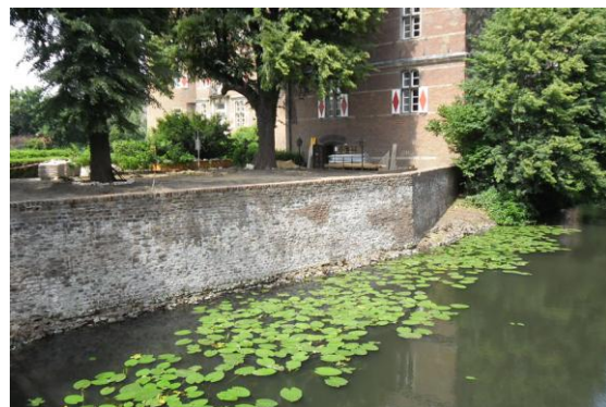
Figura 20 - Muro de suporte em alvenaria de tijolo maciço, material que também compõe as pontes (Fonte: Autor (2013))
