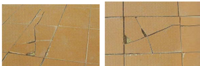
Fig. 2.8 – Fissuração de revestimentos cerâmicos
