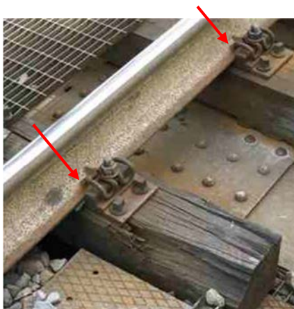
Figura 2.19 - Pormenor das marcas deixadas pelo sistema de fixação no patim do carril na zona de transição aterro-ponte de uma ponte metálica em Itália
