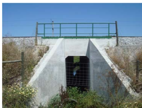
Figura 6.1 - Passagem hidráulica PH126A
