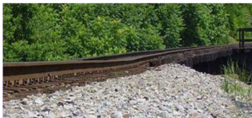
Figura 2.12 – Assentamento verificado numa zona de transição aterro-ponte (FRA, 2007)
