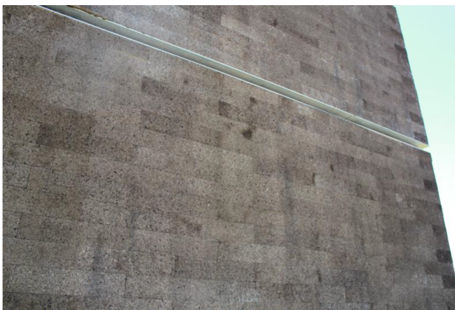
Figura 5.7 – Escorrimentos e aspeto acinzentado com tonalidades diferentes da fachada este.
