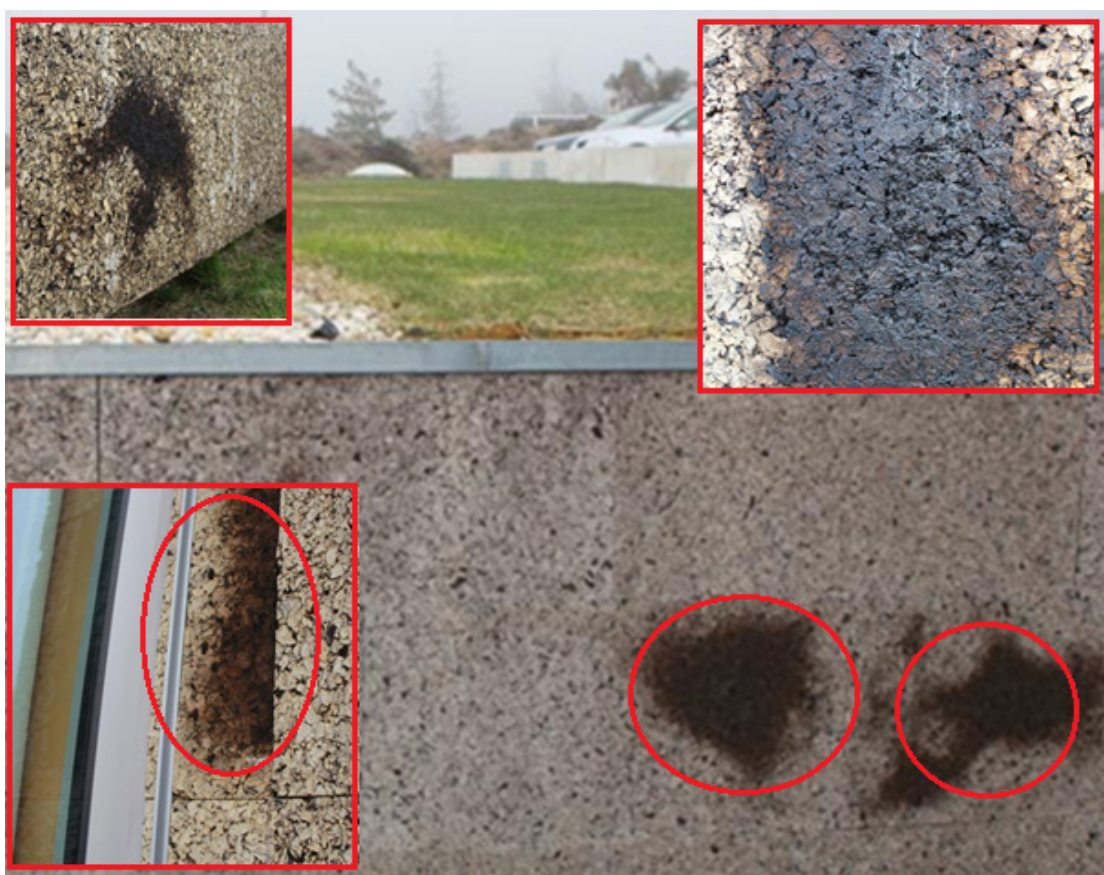
Figura 5.14 – Algumas manchas existentes no revestimento da fachada
