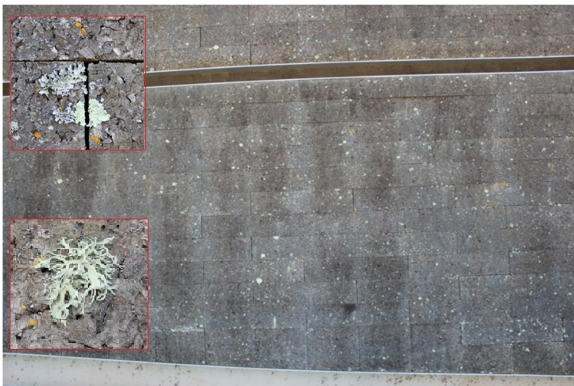
Figura 5.6 – Escorrências e distribuição de líquenes fachada norte.
