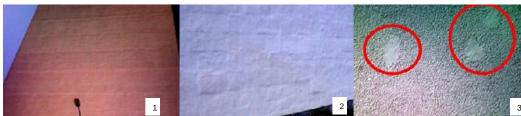
Figura 3.35 – 1 e 2 – Irregularidades, 3 - manchas de superfície.
