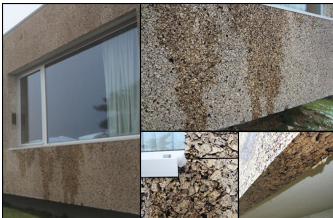
Figura 5.12 – Escorrências existentes na zona abaixo dos parapeitos das janelas.
