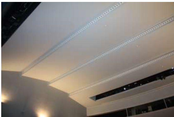
Fig. 4.6 – Teto falso, de altura variável, com grelhas de ventilação verticais [64]
