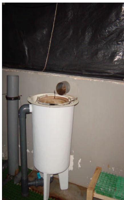
Figura 8: Tanque de recolha de ovos com cesto de rede instalado
