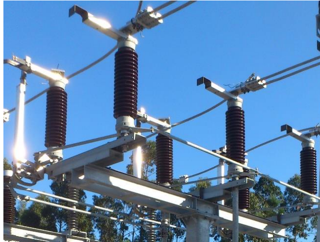
Figura 2.3 - Exemplo de um seccionador de facas rotativas
